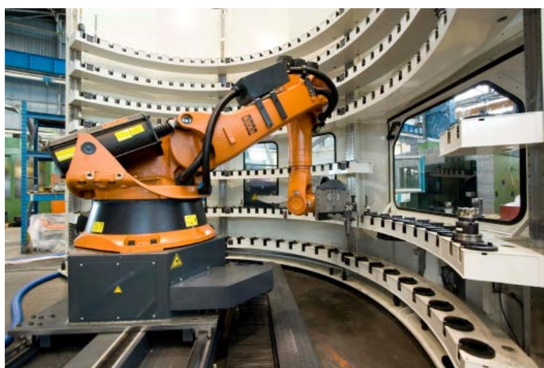
[Obr. 3.7] - ATC v provedení s robotem
