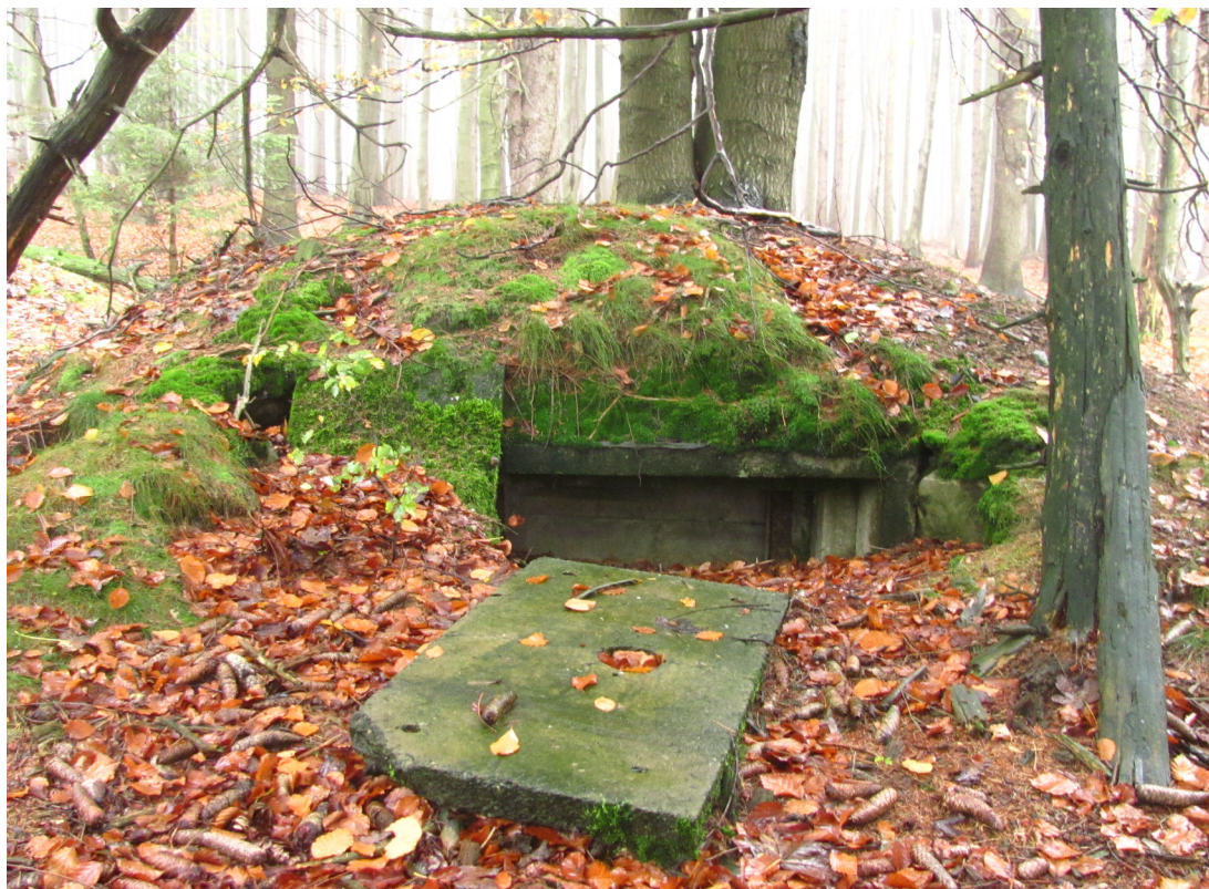
Obr. 15 – Palebný objekt KŽ-1 (PS-B-L-03). Dobře je vidět vyvalený kryt střílnové nástavby. Pohled od západu. (foto B. Nejedlá)
