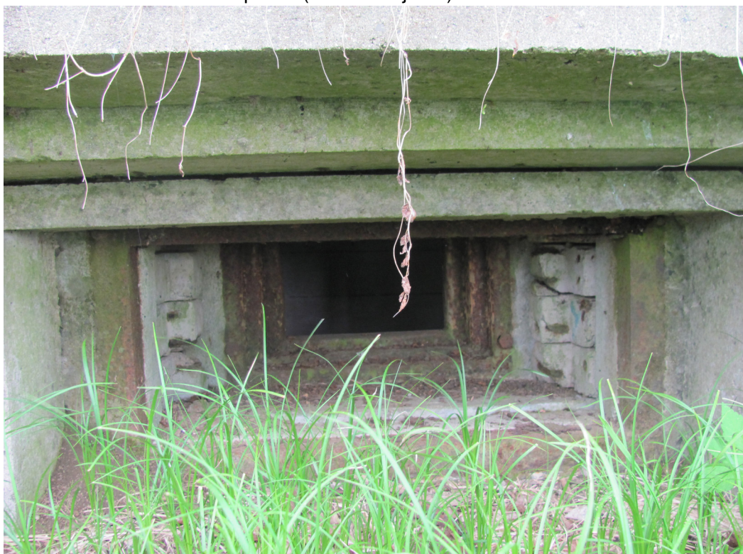
Obr. 40 - Detail střílny objektu S-B-P-01, který ukazuje že byla vytržena ocelová část střílny. (foto B. Nejedlá)
