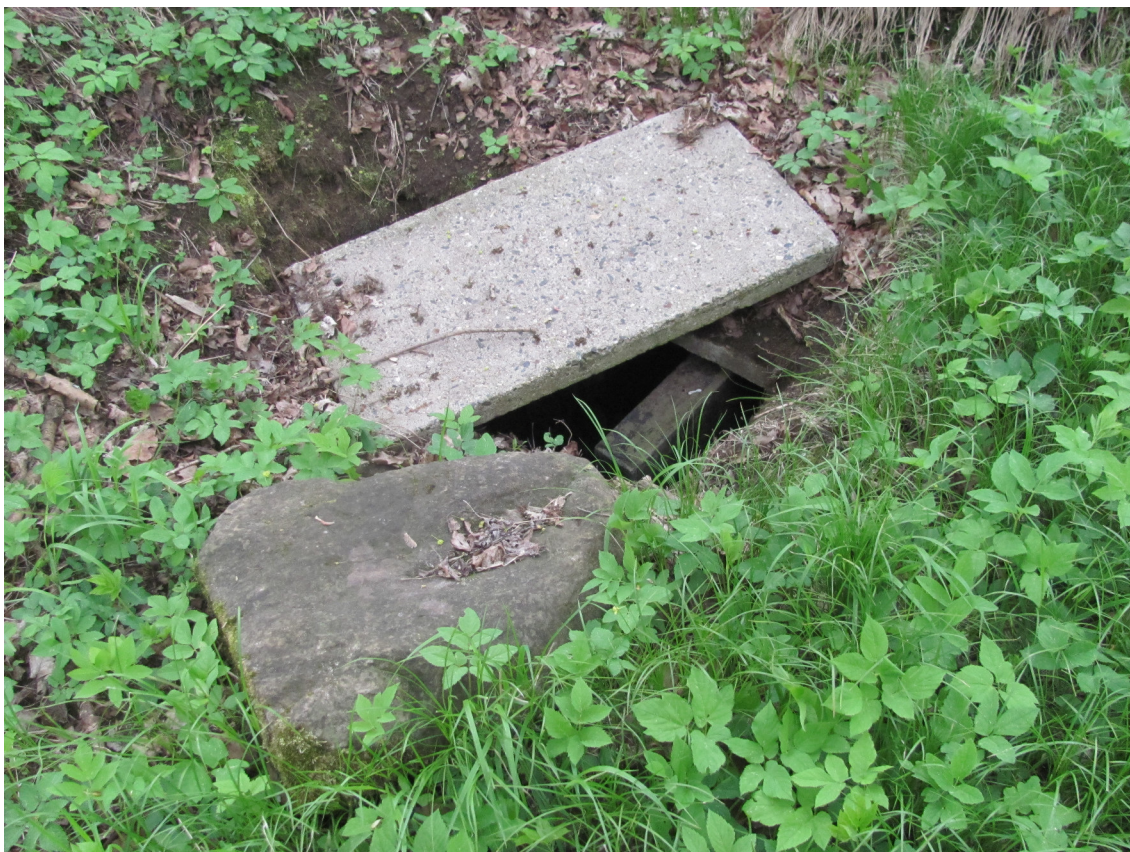
Obr. 41 – Detail vstupu objektu S-B-P-01, na němž je patrné nedávné narušení objektu. (foto B. Nejedlá)
