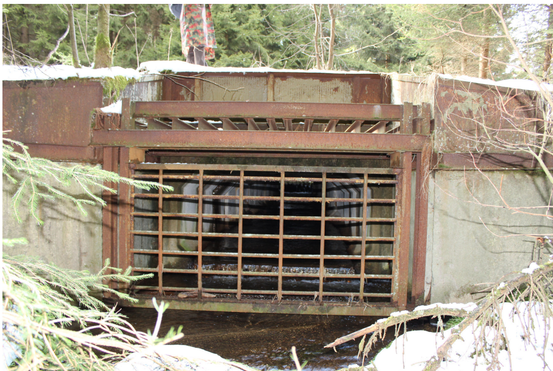
Obr. 27 – Pohled na vnitrozemskou stranu vodní zábrany na jednom z přítoků Studeneckého potoka (PS-VZ-01). V tunelu jsou dobře vidět prefabrikované dílce z nichž je složen. (foto J. Čibera)
