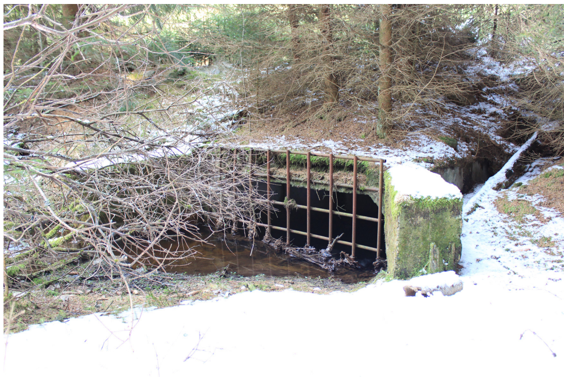
Obr. 30 - Vodní zábrana (PS-VZ-01). Strana od státní hranice. (foto J. Čibera)
