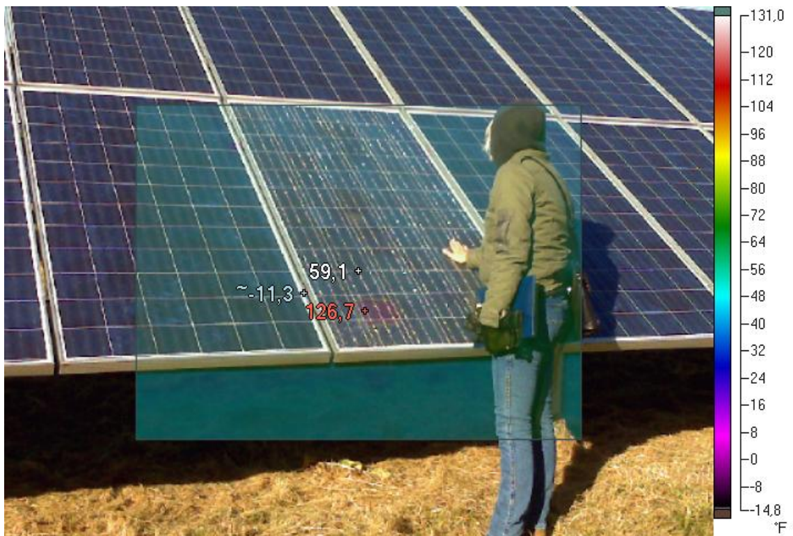
Termografické proměření poškozeného panelu s vyznačení teplotních odchylek.
