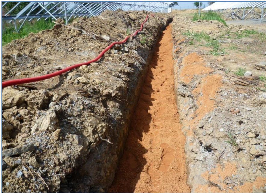
Obr. 13 Příklad trasy AC kabeláže od střídačů k trafostanici 22kV
