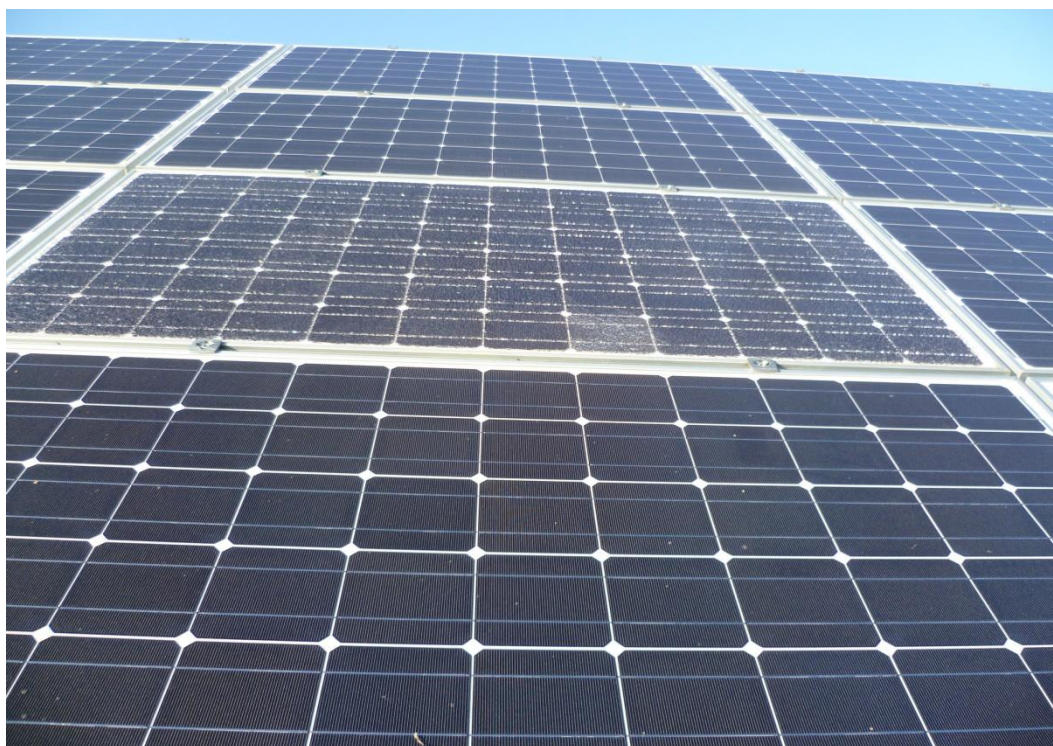
Panel s poškozeným (prasklým) krycím sklem.
