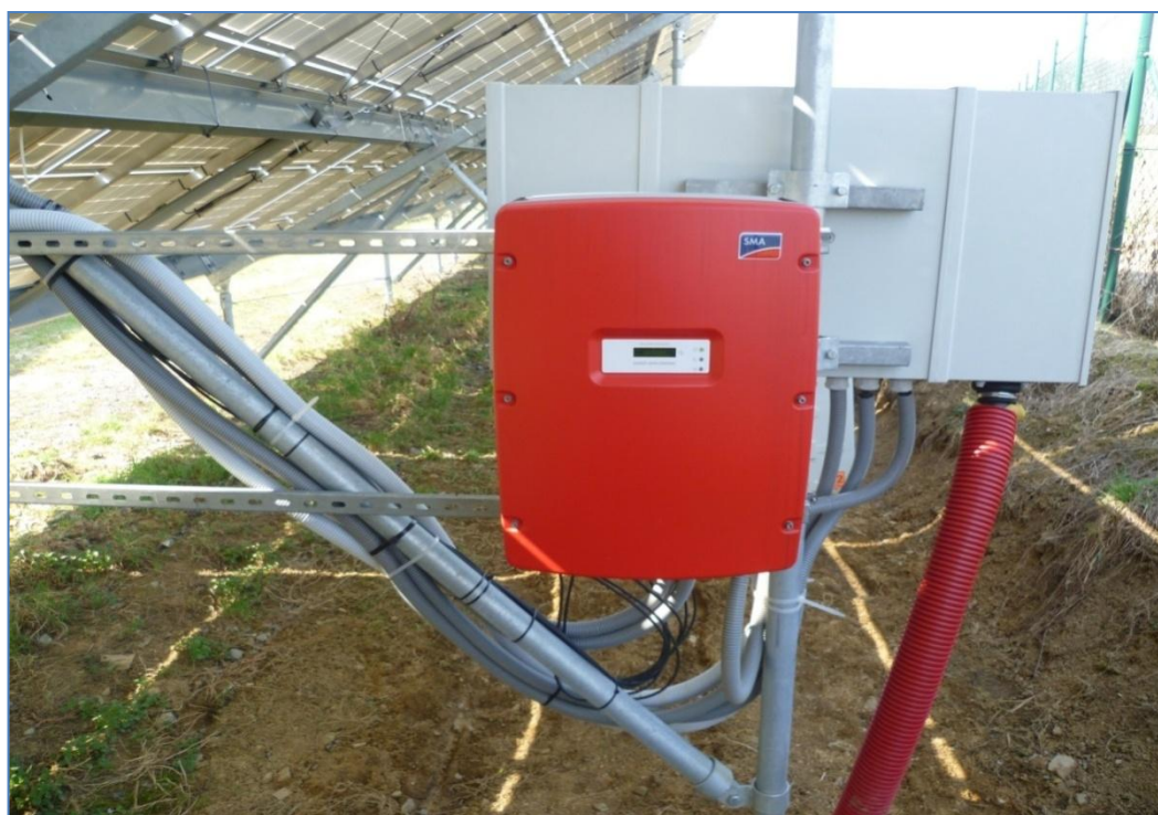
Obr.12 Stringy vedoucí stejnosměrný proud do střídače SMA
