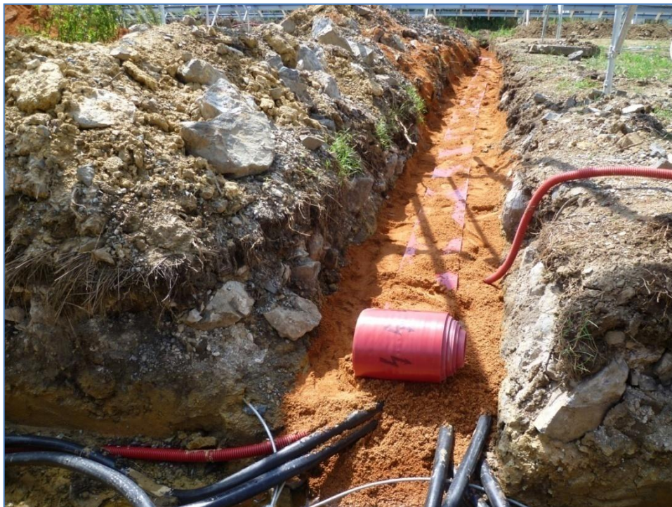
Obr. 10 Příklad uložení AC kabeláže o průřezu 240 mm 2 v pískovém loži s ochrannou folií
