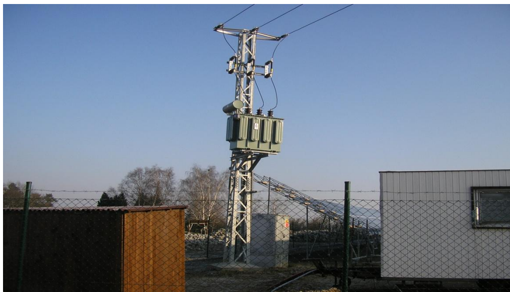
Obr. 14 Transformace napětí na hladinu 22 kV – olejový sloupový transformátor
