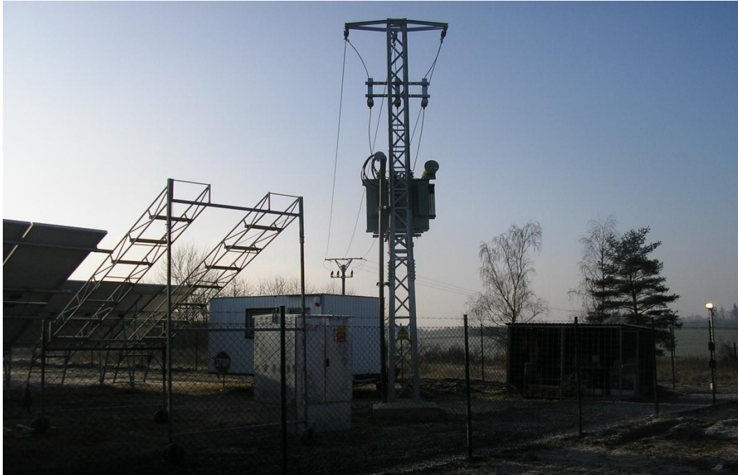
Vyvedení výkonu FVE do sítě ČEZ vzdušnou přípojkou 22kV.
