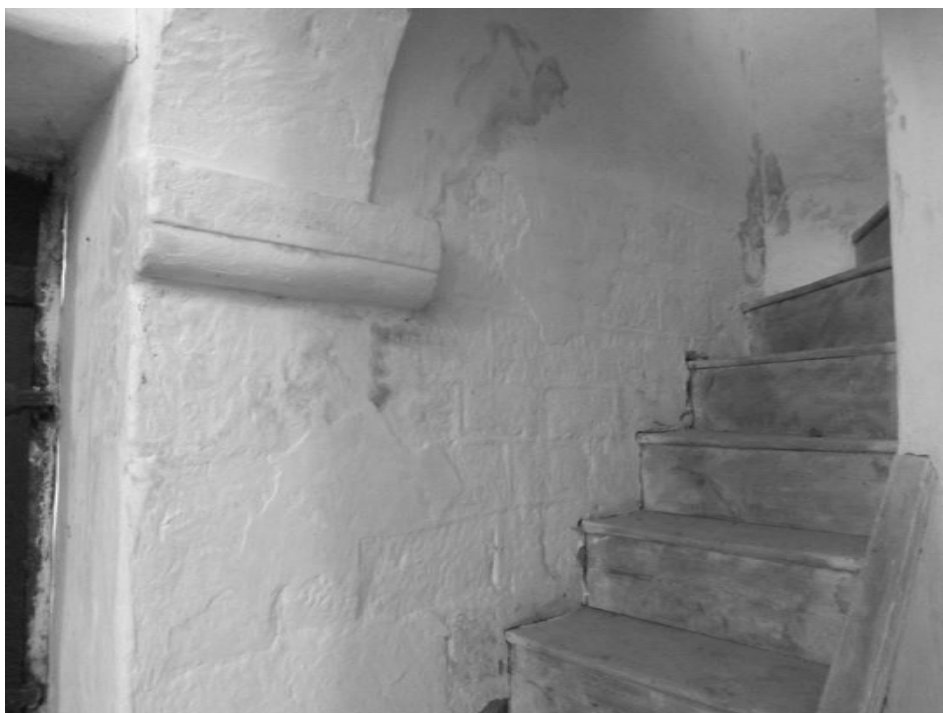
Obr. 7. Prosvítající režné zdivo pod omítkou
