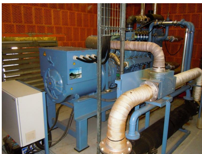
Obrázek 8: Druhá kogenerační jednotka BPS Všeruby o výkonu 230 kW
