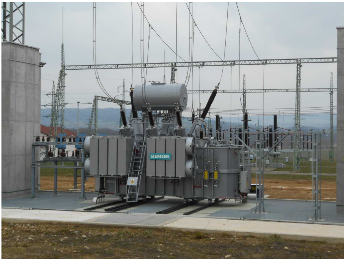
Obr. 15 Transformátor 220/110 kV, 200 MVA
