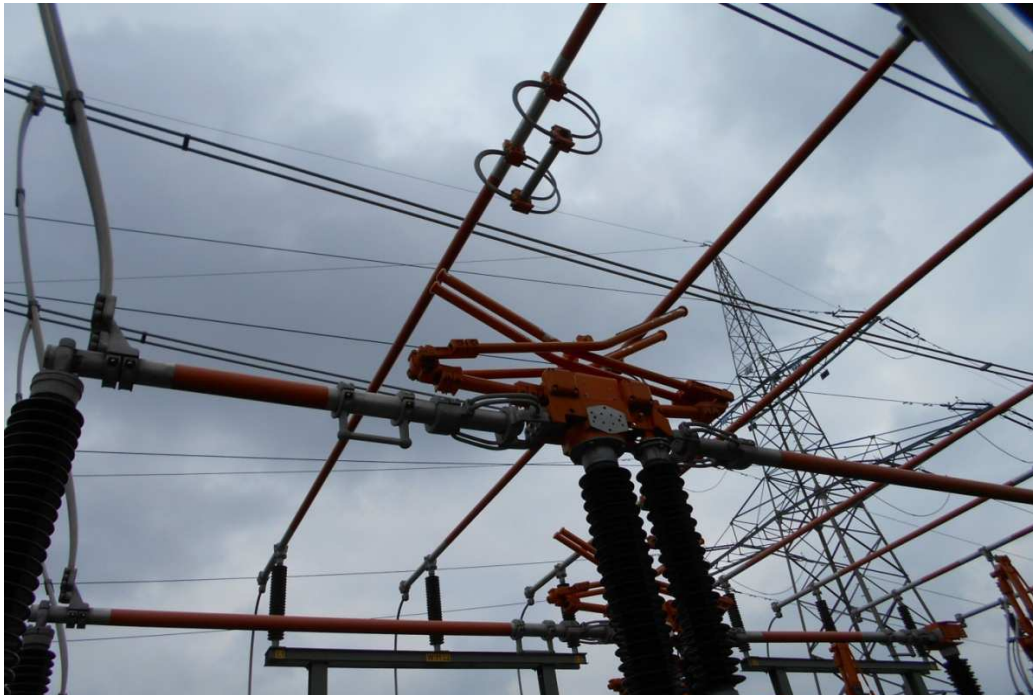
Obr. 7 Pantografový odpojovač 400 kV
