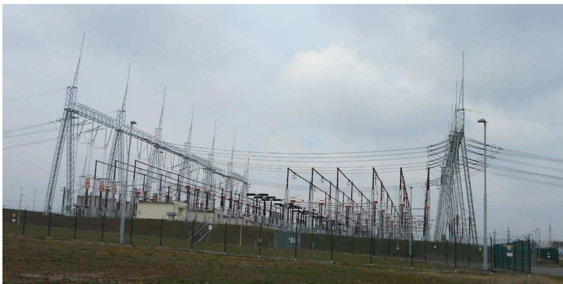
Obr. 3 Venkovní rozvodna 400 kV
