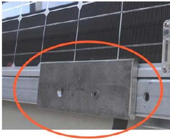
Obr. 30 Fotovoltaický panel zastíněný prvkem nosné konstrukce [8]
