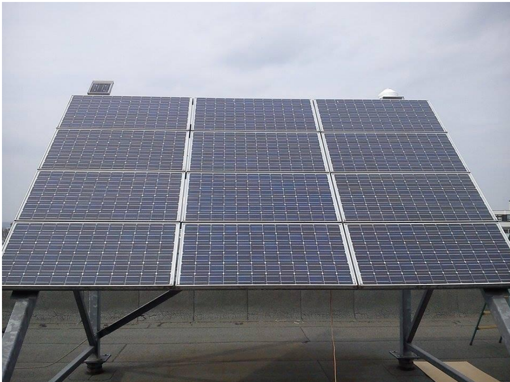
Obr.1.4 Instalované panely na střeše ZČU [vlastní zdroj ]
