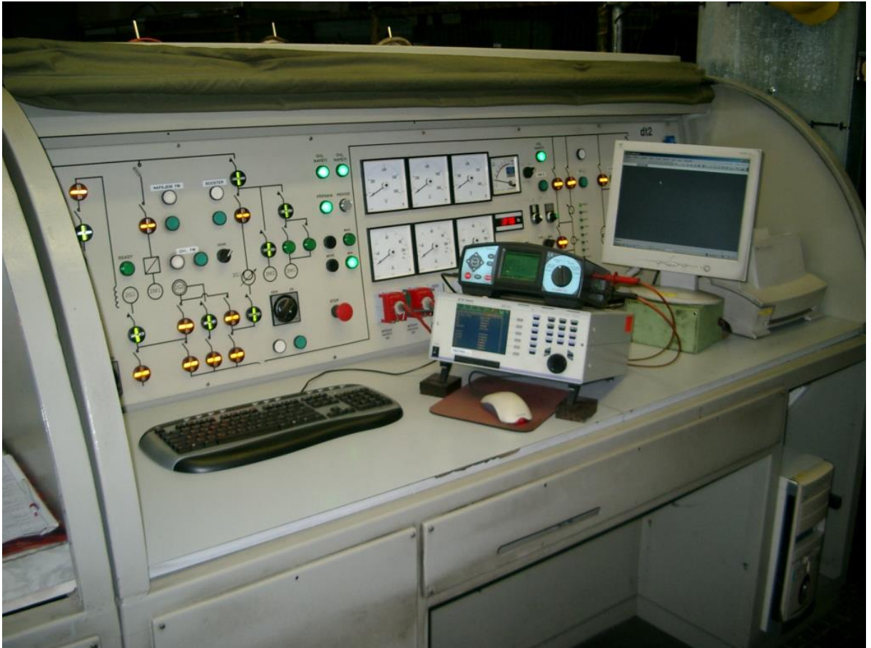
Obr. 3.1 Ovládací pult zkušebny Sobědruhy společnosti Omexom GA Energo s.r.o.
