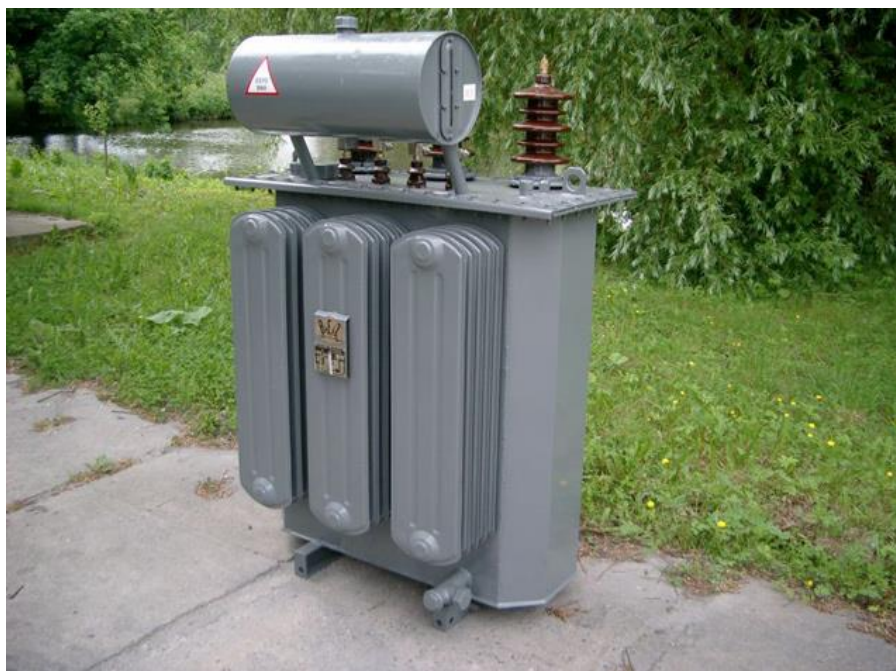
Obr. 1.1 Repasovaný transformátor společnosti Omexom GA Energo s.r.o.
