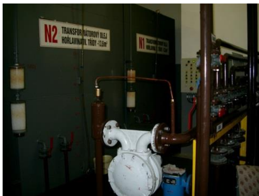
Obr. 4.2 Nádrže na olej, rozvaděč olejového hospodářství
