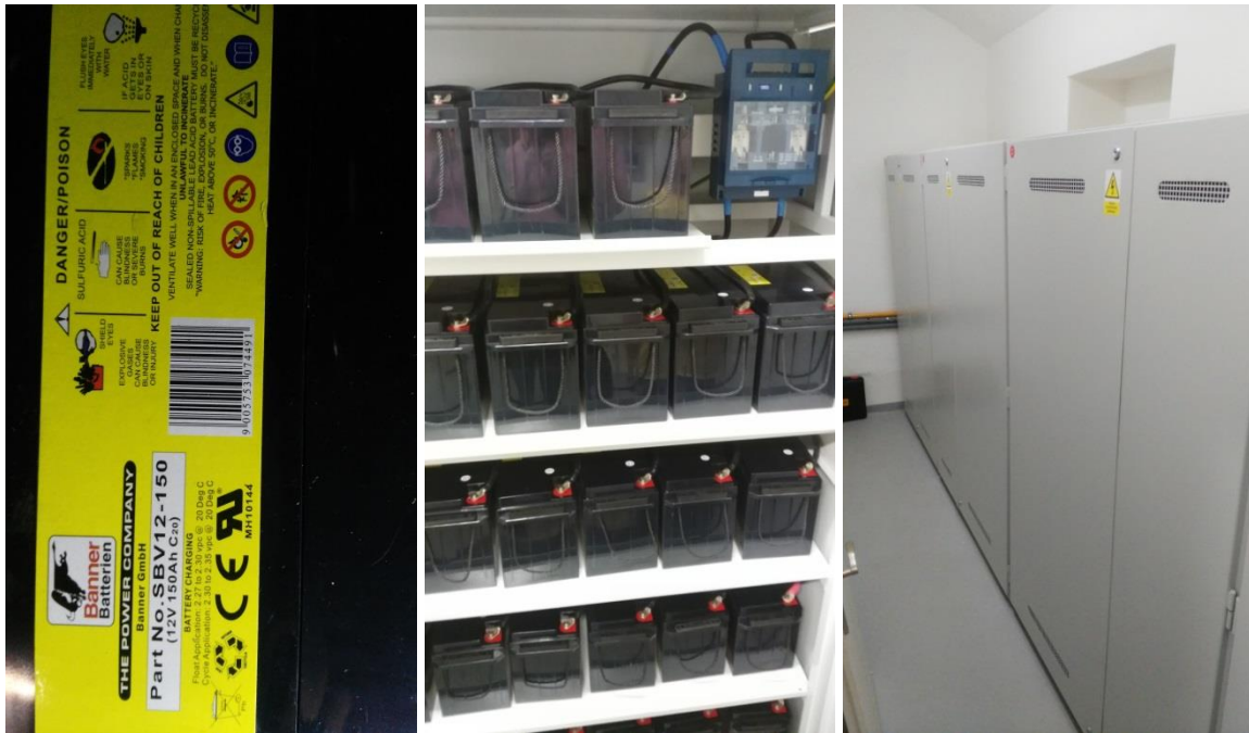
Obr. 16 a) Štítek použitého akumulátoru. b) Náhled na jeden z akumulátorových boxů. c) Pohled do akumulátorovny
