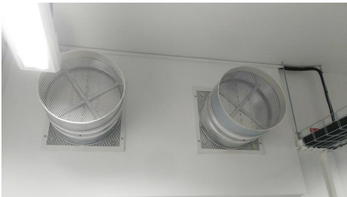
Obr. 5 Požární přetlakové klapky stabilního hasebního zařízení.
