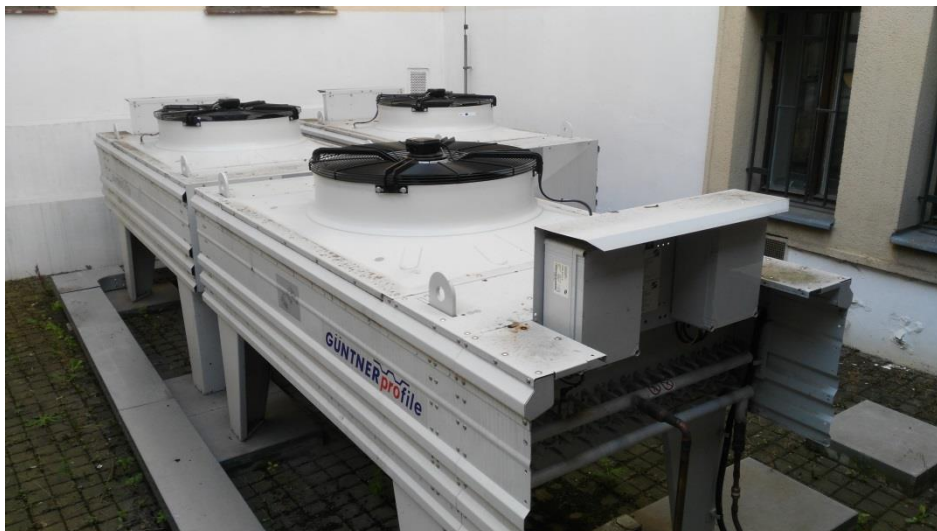
Obr. 20 Venkovní kondenzátorové jednotky Güntner
