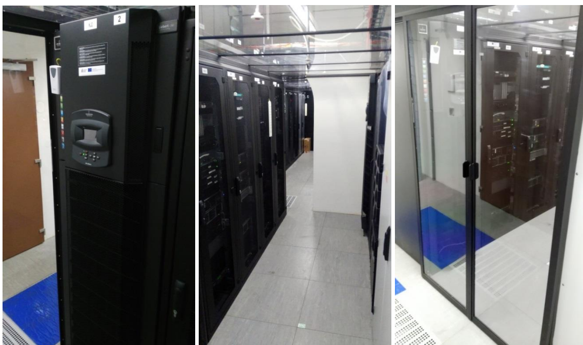
Obr. 19 a) Meziracková jednotka EMERSON. b) Pohled do studené uličky. c) Vstup do studené uličky přes posuvné dveře.
