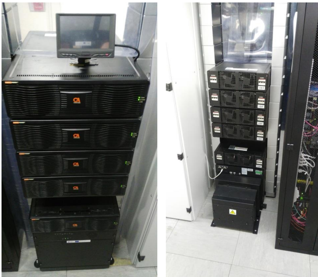
Obr. 7 Záložní zdroj UPS Gamatronic v konfiguraci se šesti moduly po 25kVA. Na obrázku je stav, kdy jeden z modulů je v reklamaci.
