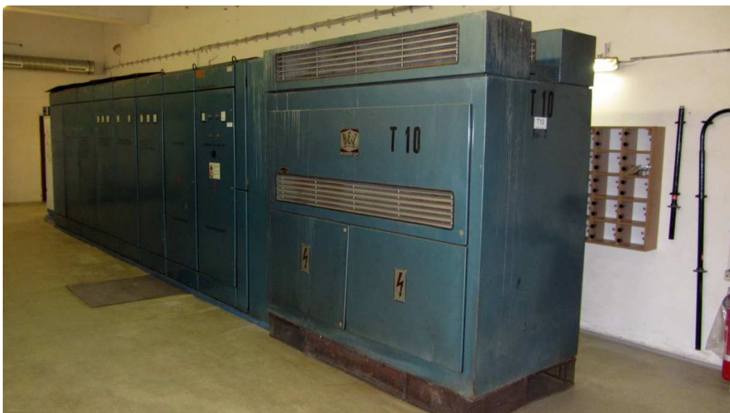
Obr. 3 Rozvodna E109 – pohled na rozvaděč RM2 v bloku s transformátorem T10 [1]
