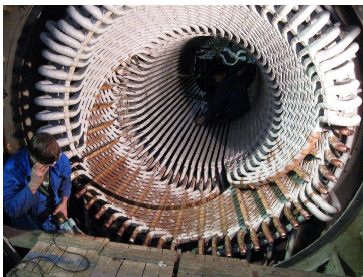
Obrázek 5: Výměna části vinutí. Na obrázku je patrné uspořádání statorových tyčí a čel vinutí [7]
