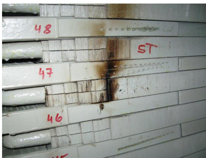
Obrázek 7: Průraz izolace statorového vinutí vzniklý v důsledku chvění [7]
