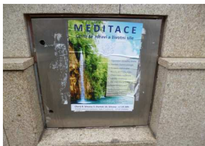
Obr. č. 44: Nelegální reklama na krytu elektrického rozvaděče
