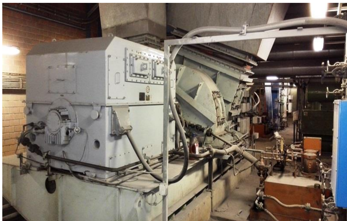
Elektrárna Tisová – spalínový ventilátor K12. Zdroj: [vlastní fotografická dokumentace, 2015]
