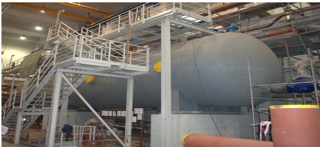
Obr.15 Reálná fotka napájecí nádrže v ELE Ledvice
