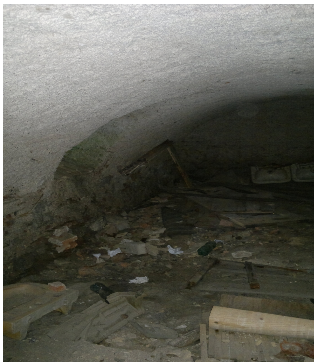
Sklepy na faře – na zdech je patrný nános betonové omítky.
