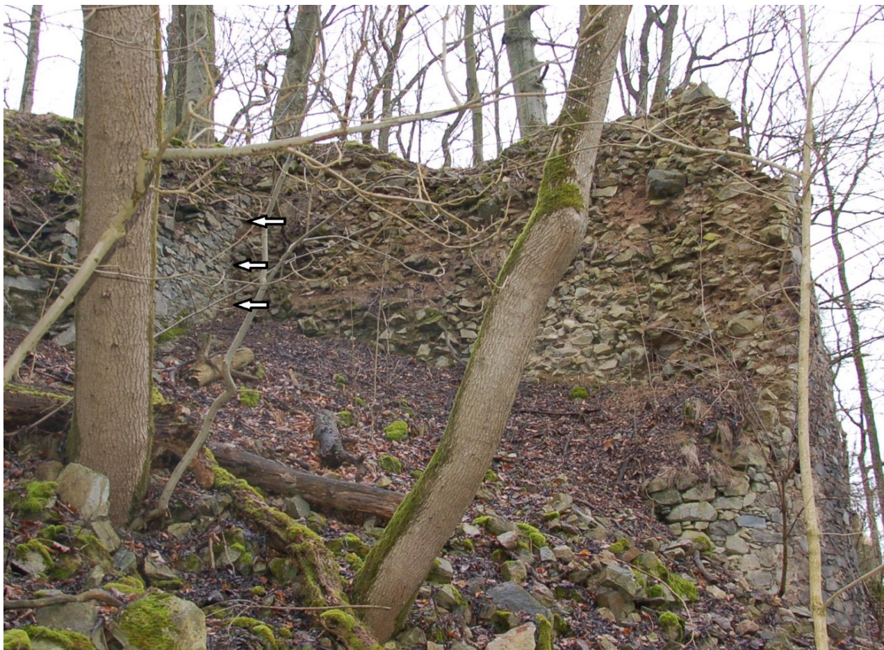
Obr. 47. Nový Herštejn. Způsob provedení napojení (na spáru) objektu s tzv. Panenskou věží k vnějšímu líci východní obvodové hradby (místo označeno šipkami). Pohled z prostoru přístupové cesty od jihovýchodu (foto 30. 1. 2016 a úprava autor).
