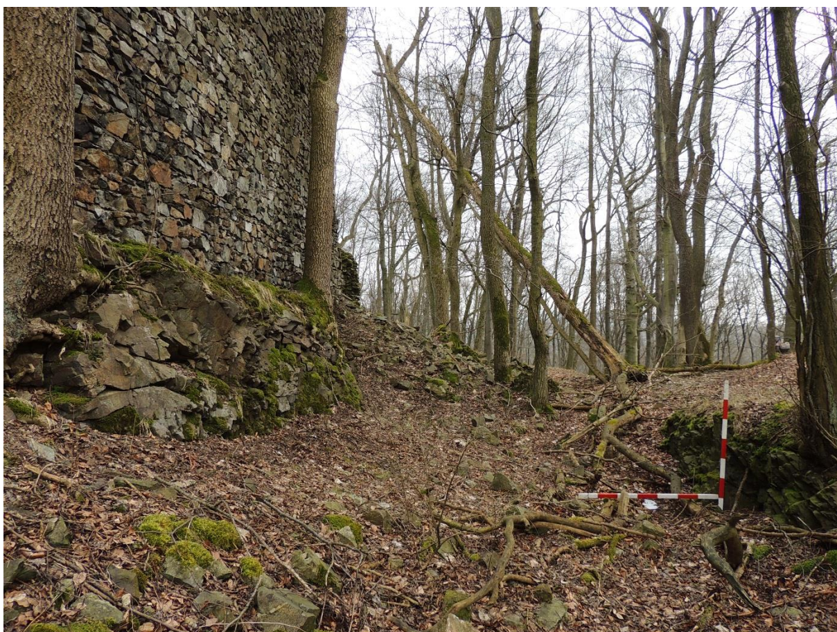
Obr. 97. Nový Herštejn. Západní úsek hradního příkopu vylámaný ve skále. Lat' 1.4 m (foto autor 19. 3. 2016).
