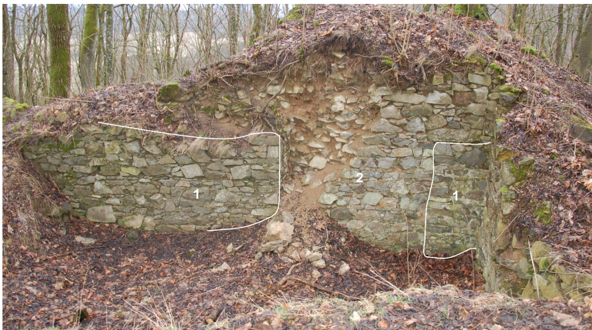
Obr. 45. Nový Herštejn. Nádvořní stěna východní části obvodové hradby v místě zazděného vstupu do podkovovité bašty. (1) původní zdivo z 2. pol. 14. století. (2) mladší zazdívka z konce 15. století. Pohled od východní stěny donjonu (foto 30. 1. 2016 a úprava autor).
