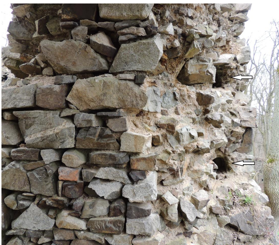
Obr. 26. Nový Herštejn. Otvory pro uložení zajišťovacích trámů dveří (označeno šípkami) v místě vstupu do druhého patra donjonu (foto 2. 4. 2016 a úprava autor).
