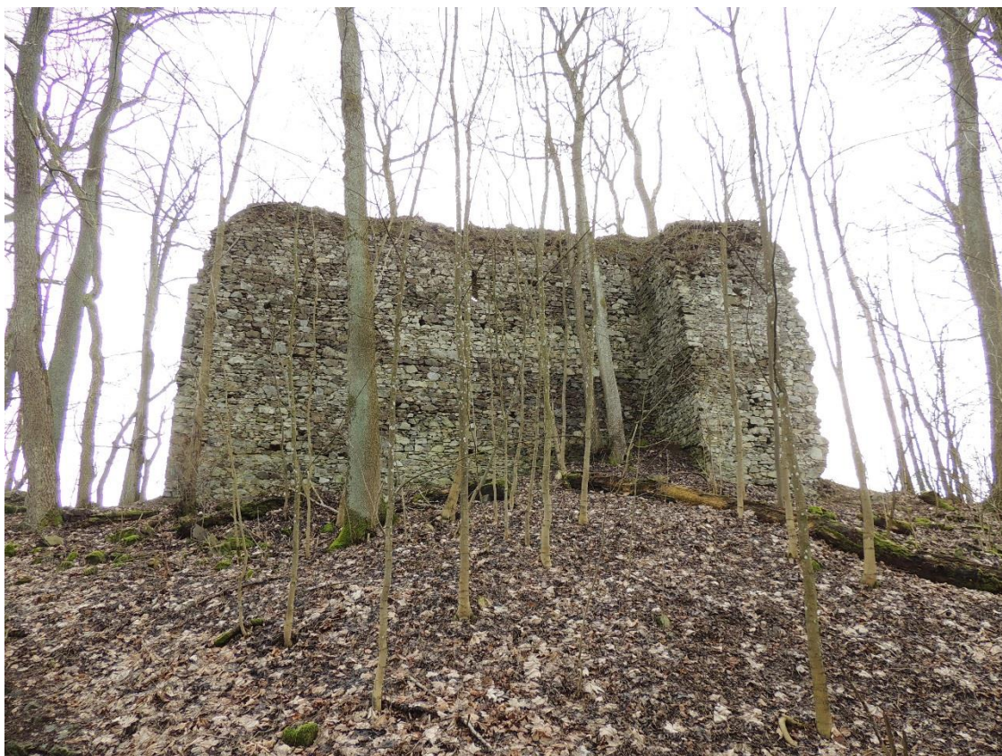
Obr. 19. Vnější líc severní zdi donjonu s částí zdi jádra hradu, která je připojena k severozápadnímu nároží (foto 30. 1. 2016 a úprava autor).
