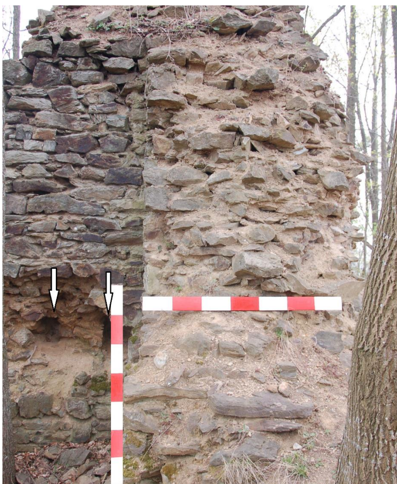
Obr. 161. Pušperk.. Jihovýchodní roh donjonu s otvory po stropních trámech v úrovni prvního podlaží (označeno šipkami). Lat' 1.4 m (foto 6. 4. 2016 a úprava autor).
