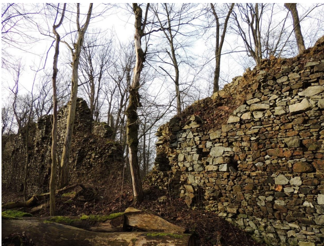
Obr. 56. Nový Herštejn. Silně destruovaná část severní obvodové hradby. Pohled na nádvoří část (foto autor 30. 1. 2016).
