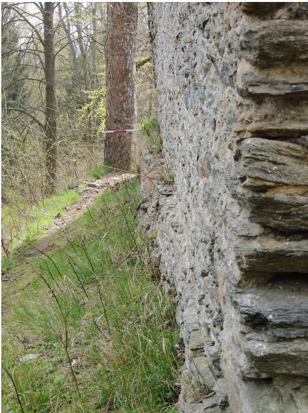
Obr. 120. Pajrek. Odsazení základového zdiva donjonu v severovýchodním nároží. Jeden dílek latě 0.2 m (foto autor 22. 4. 2016).
