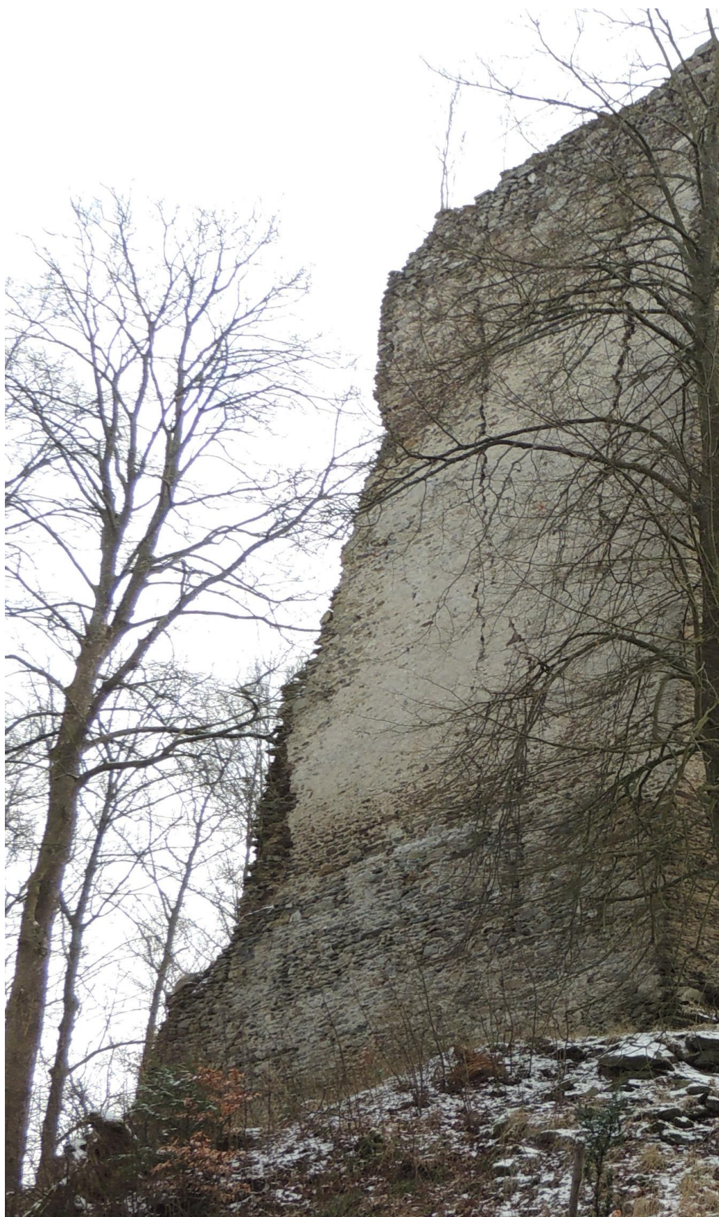
Obr. 122. Pajrek. Severní stěna donjonu se znatelným pásem původní omítky v úrovni druhého a třetího patra (foto autor 2. 1. 2016)
