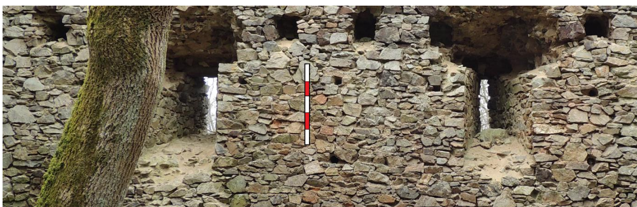
Obr. 32. Nový Herštejn. Štěrbinové otvory v západní zdi prvního patra interiéru donjonu. Lat' 1 m. (foto autor 2. 4. 2016).
