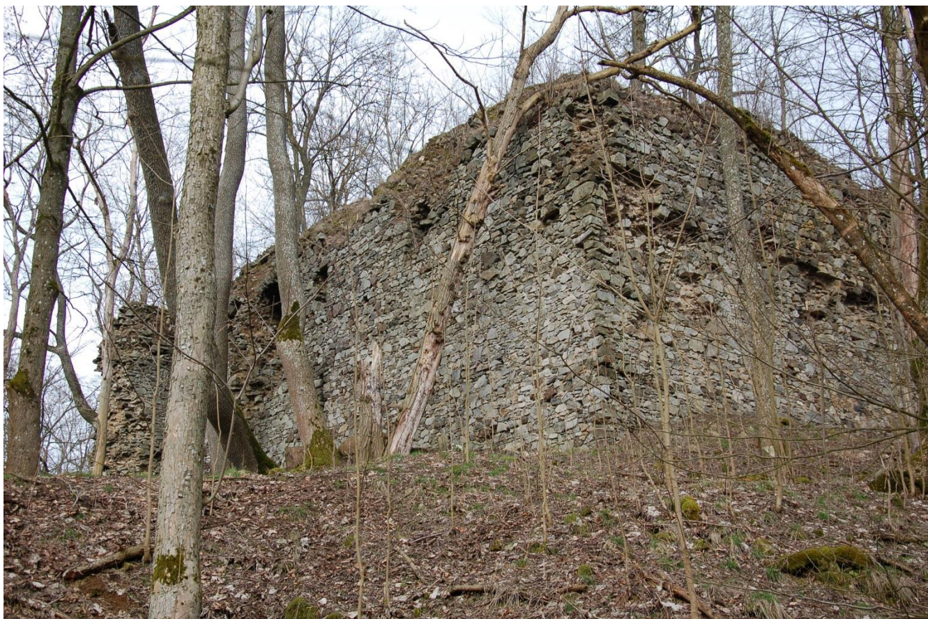
Obr. 17. Nový Herštejn. Jihozápadní nároží donjonu v pohledu od hradní cisterny (foto autor 20. 3. 2016)
