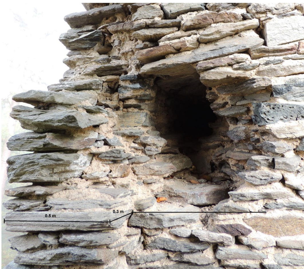
Obr. 130. Pajrek. Relikt zděné zárubně původního vstupu do donjonu. (foto 24. 10. 2015 a úprava autor).
