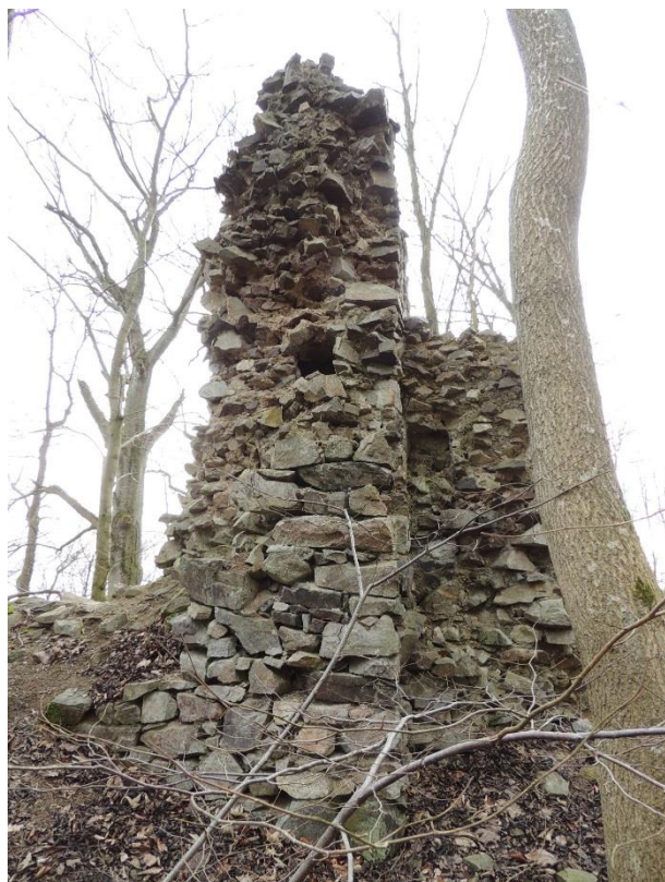
Obr. 68. Nový Herštejn. Špaleta vstupního otvoru v úrovni prvního patra do objektu v jižním cípu obvodové hradby (foto autor 8. 2. 2016).
