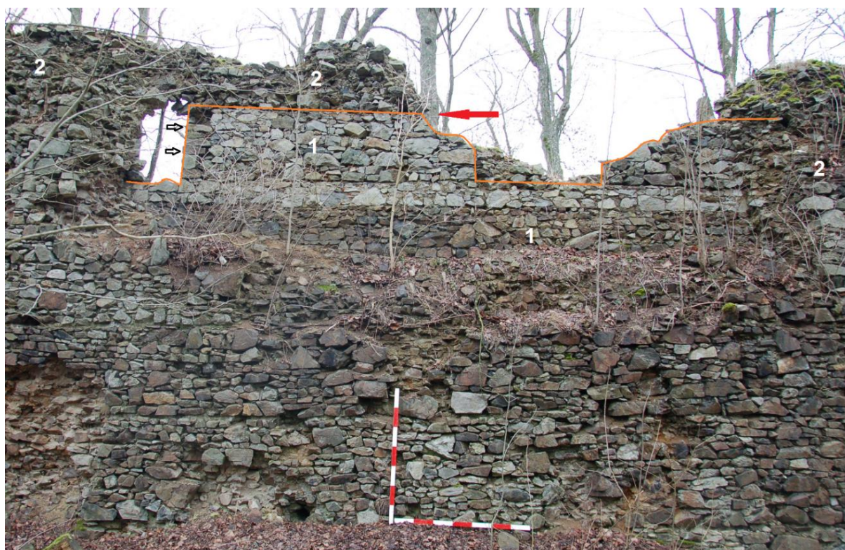
Obr. 54. Nový Herštejn. Nádvoří strana severní obvodové hradby s destrukcí nadezděné části, která odhalila původní stínku. Hrana stínky označena šipkami. (1) původní zdivo z poloviny 14. stol. (2) zdivo z konce 15. stol. Červenou šipkou označena úroveň koruny původní stínky. Lat' 1.4 m (foto 30. 1. 2016 a úprava autor).
