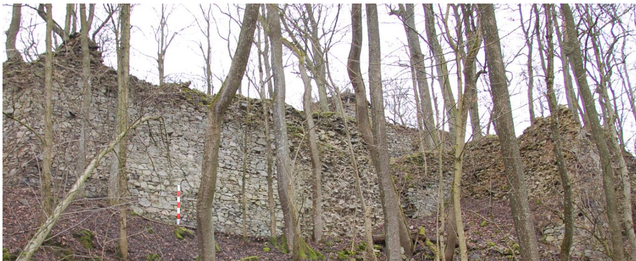
Obr. 88. Nový Herštejn. Jižní úsek východní části obvodové hradby od jihovýchodního nároží k objektu s tzv. Panenskou věží. V severní části je patrná destrukce vnějšího líce. Lať 1.4 m (foto autor 31. 1. 2016).
