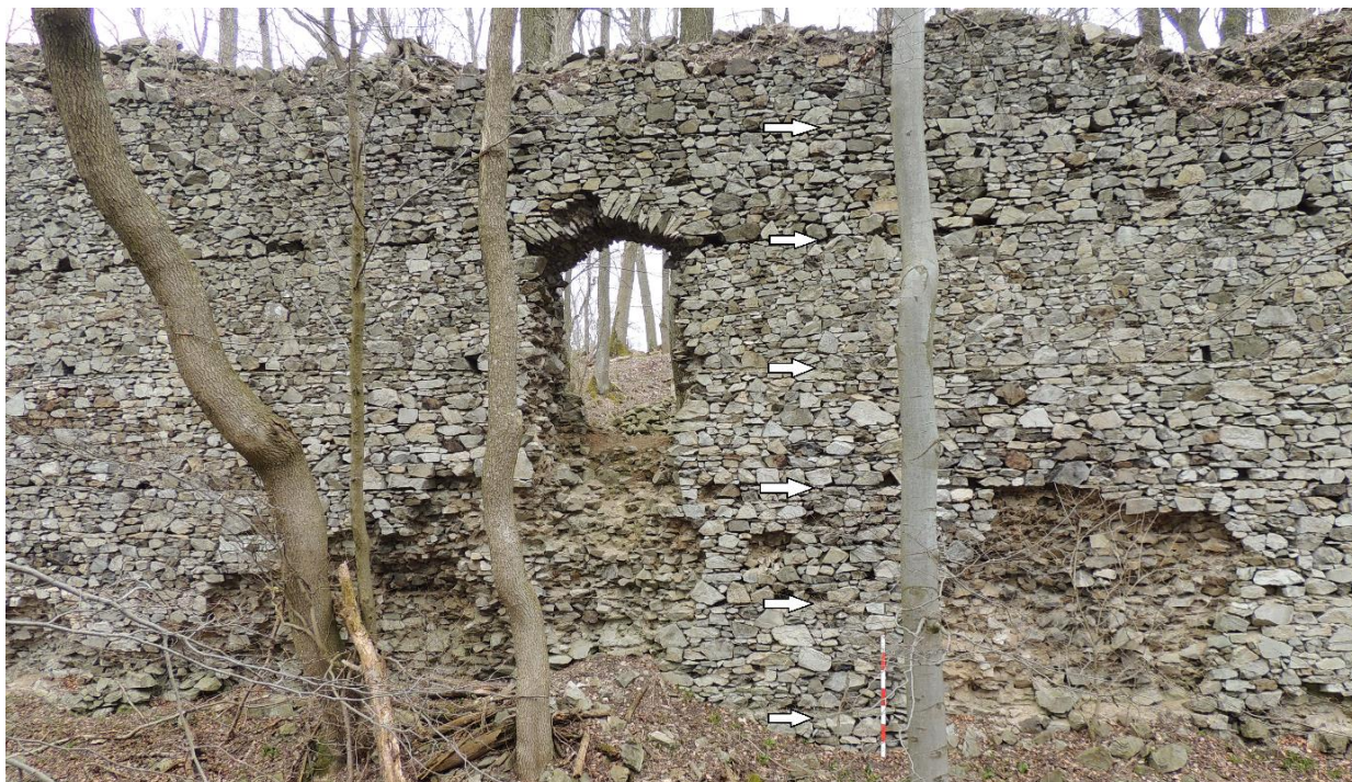
Obr. 80. Nový Herštejn. Úsek jihozápadní obvodové zdi s tzv. výpádovou brankou. Jednotlivé stavební úseky hradby jsou označeny šípkami. Lať 1.4 m (foto 19. 3. 2016 a úprava autor).
