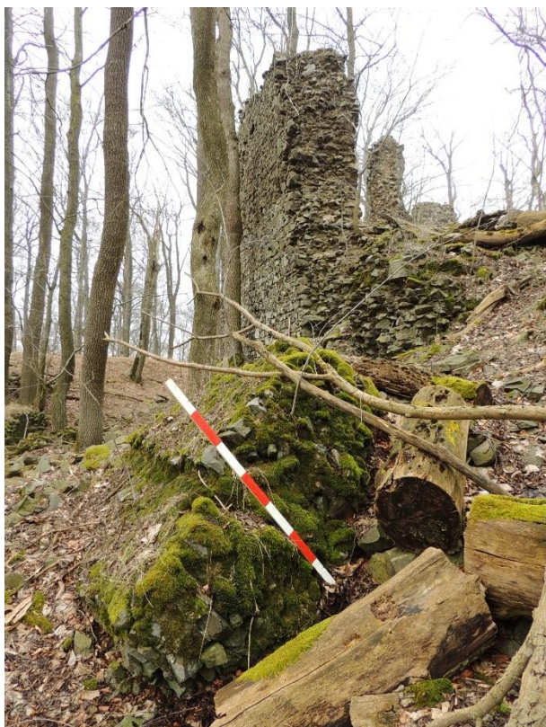
Obr. 64. Nový Herštejn. Blok kompaktního zdiva jihozápadní obvodové hradby sesutý v příkopu. Lať 1.4 m (foto 19. 3. 2016 autor).
