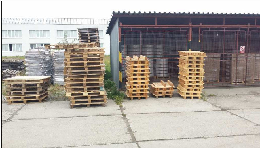
Obrázek 4-11: Nevhodný povrch zásobovacích komunikací. Na snímku je také patrný plechový přístřešek pro skladování trubiček a pryžových těsnění. [1]
