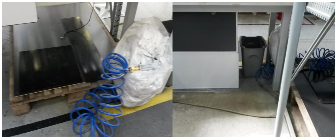
Obrázek 2-6 Původní stav přívod vzduchu
