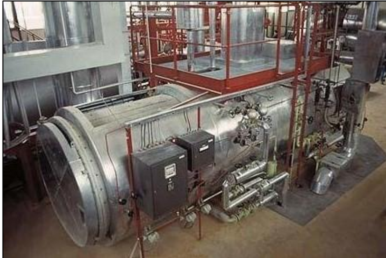
Obr. 10 Kotel spalovny odpadů[4]
