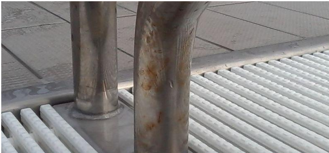
Obr. 21 Příklad koroze nerezového zábradlí bazénu po měsíci provozu [37]
