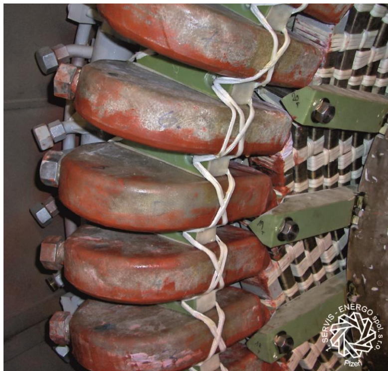
Obr. 35 Zabandážované zpevňující vložky mezi propojky vinutí, Mělník 500 MW [13]
