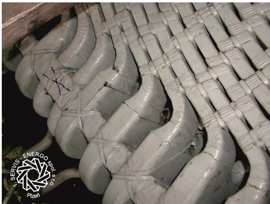
Obr. 27 Poškozené části izolace v čele vinutí, Tušimice 200 MW [13]
