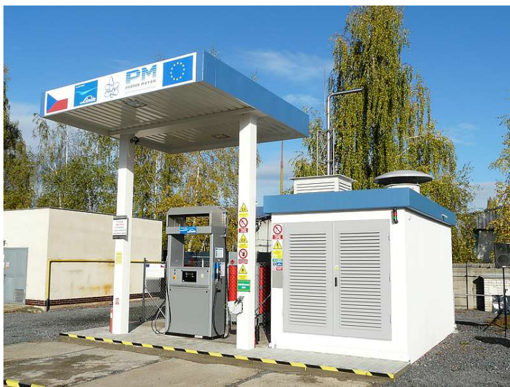
Obr. č. 35: Vodíková stanice 21
