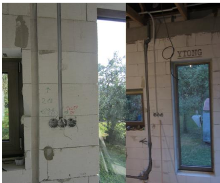
Obrázek 4.7.3: Chráněná kabelu osazená v drážce ve zdi RD
