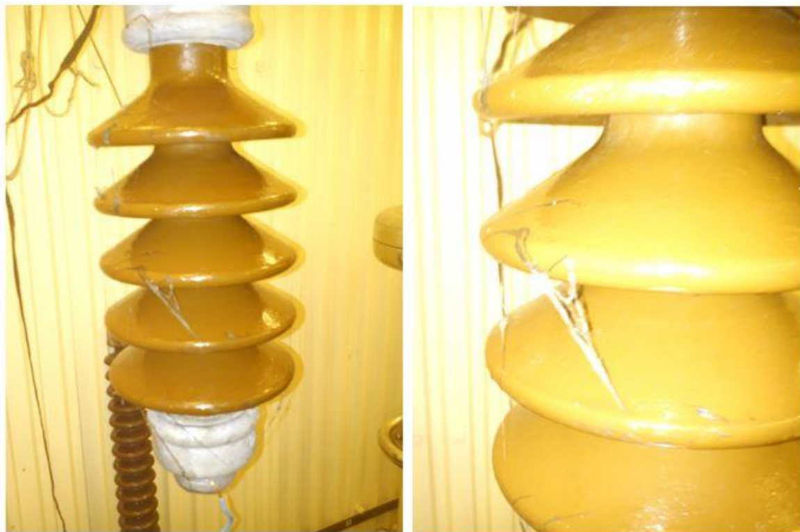
Obrázek 43: Izolátor VZL 50/435 zanesený pavučinou
