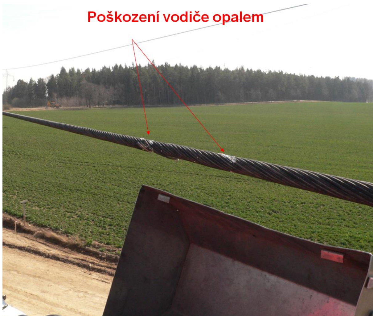
Obrázek 22: Vodič opálený po průtoku obloukového zkratového proudu [13]
