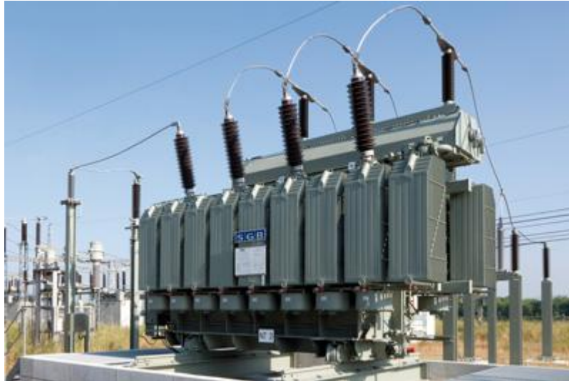
Obr. 1.1: Olejový výkonový transformátor SGB Regensburg
