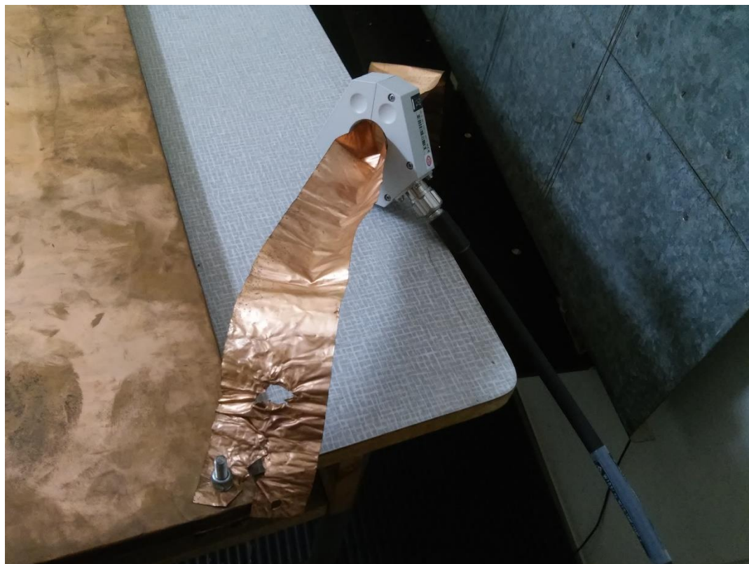
Obr. A.5: Páskové uzemnění s připojenou proudovou sondou EZ-17 výrobce R&S
