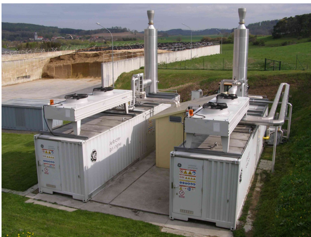
Obr. 16: Kogenerační jednotky v kontejnerech (foto autor)
