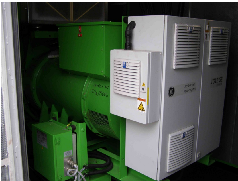
Obr. 17: Synchronní generátor v kogeneračním modulu (foto autor)
