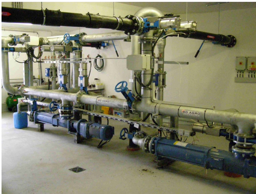
Obr. 14: Rozvody a čerpadla substrátu (foto autor)
