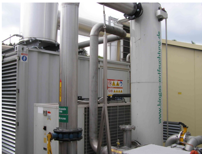
Obr. 15: Přívod bioplynu s chladicí jednotkou (foto autor)
