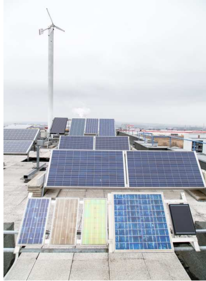
Obr.: 10 - Různé druhy fotovoltaických panelů na střeše budovy FEL ZČU
