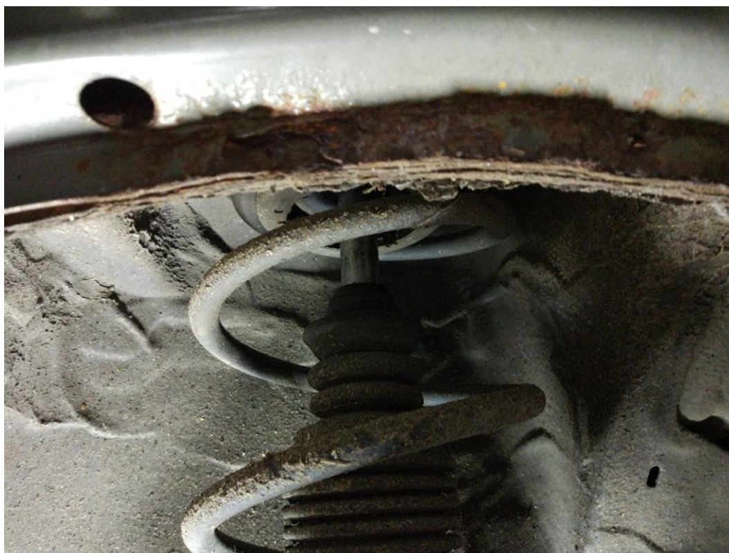
Obrázek 18 - Koroze viditelná před opravou
