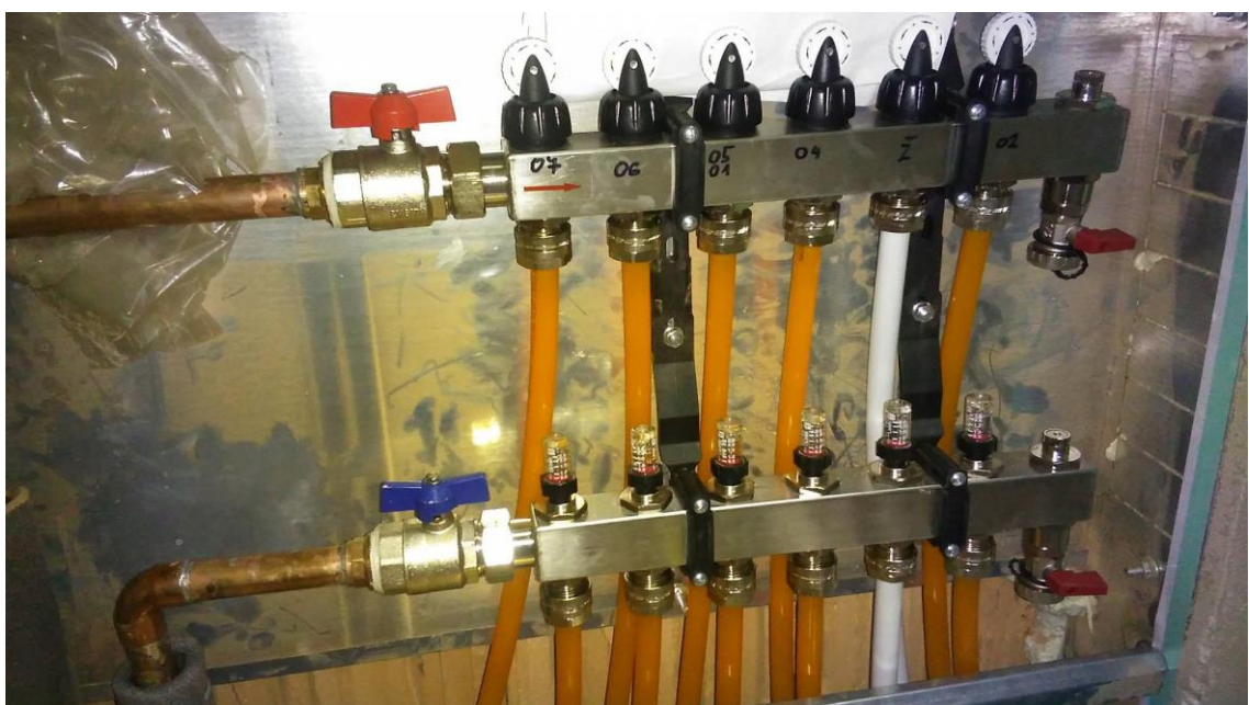
Obr. 5.1 Rozvaděč podlahového topení
