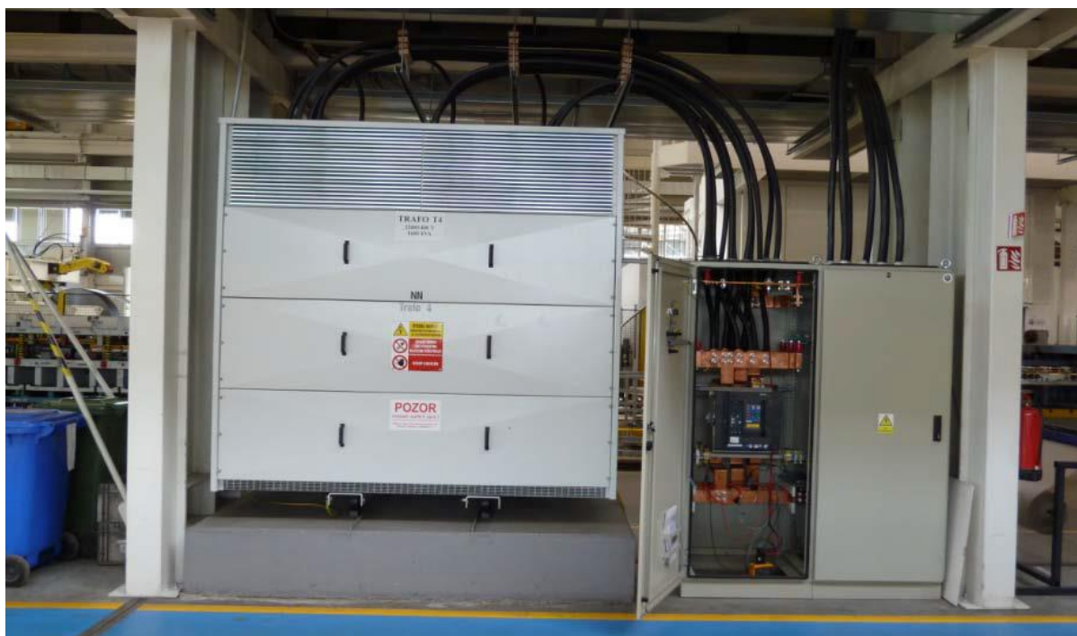
Obrázek 3: Transformátor VN/NN a rozvaděč NN napájecí oba lisy [10]
