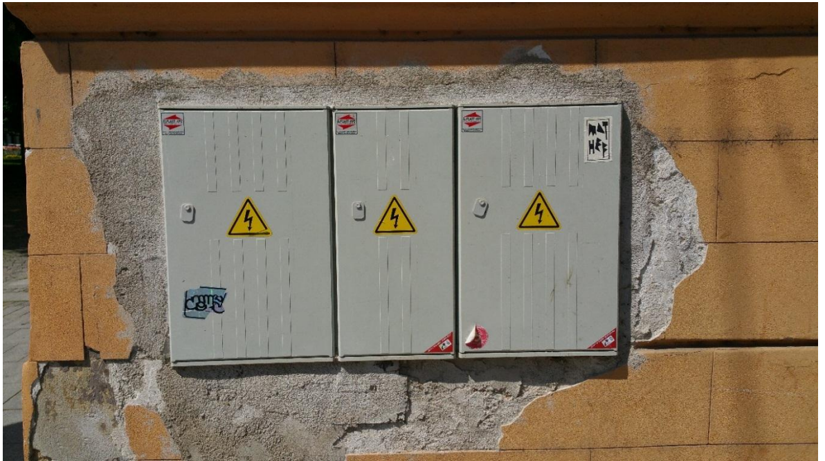
Obr. 4: Rozvaděčová skříně – Plzeň, Františkánská ulice
