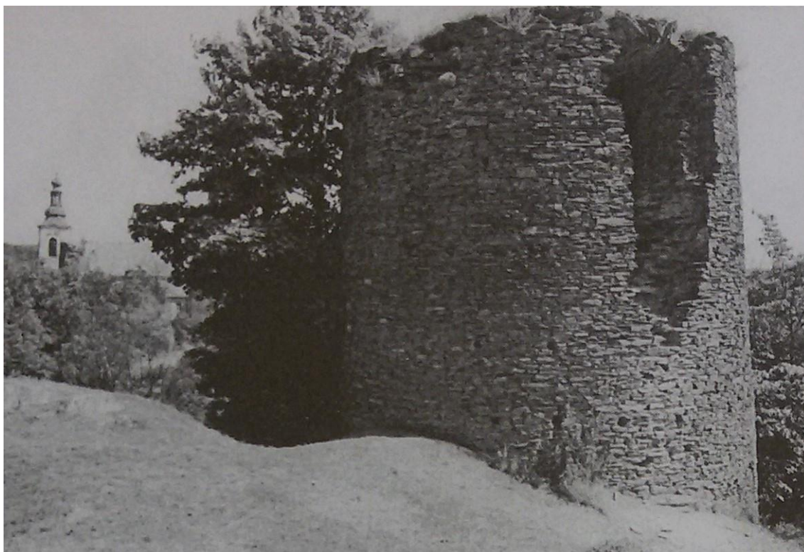
Obr. 25: Destruovaný vchodový portál bergfritu před opravou v 70. letech 20. století (zdroj Durdík 2000, 534).
