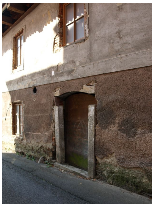
Obrázek 61: Zřícené ostění bočního vstupu domu č.p. 2 na náměstí Míru. 2016. Zdroj: vlastní
