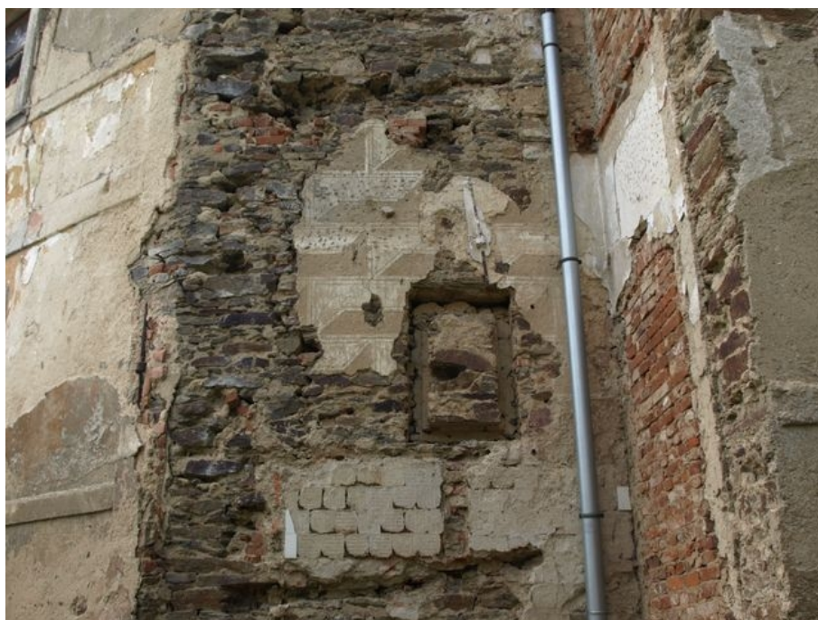
Obrázek 95: Relikt renesančních omítek. Pod ním otisk po dlaždičkách z přístavby koupelny z pol. 20. stol. 2016. Zdroj: vlastní
