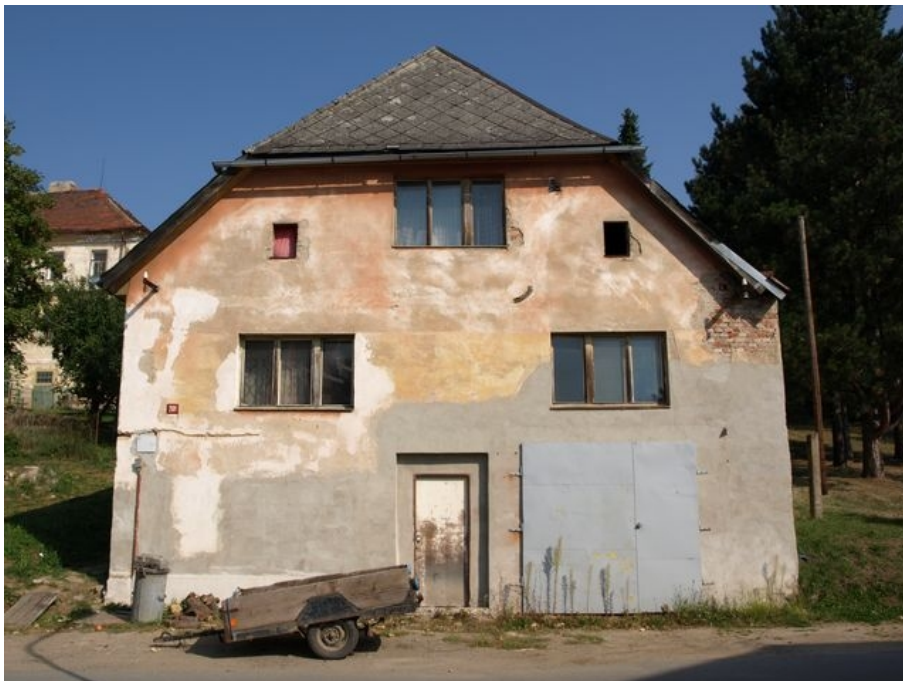
Obrázek 36: Jižní uliční průčelí domu č.p. 261. Jeden z původních objektů. Dnes ve velmi špatném technickém stavu. 2016. Zdroj: vlastní.
