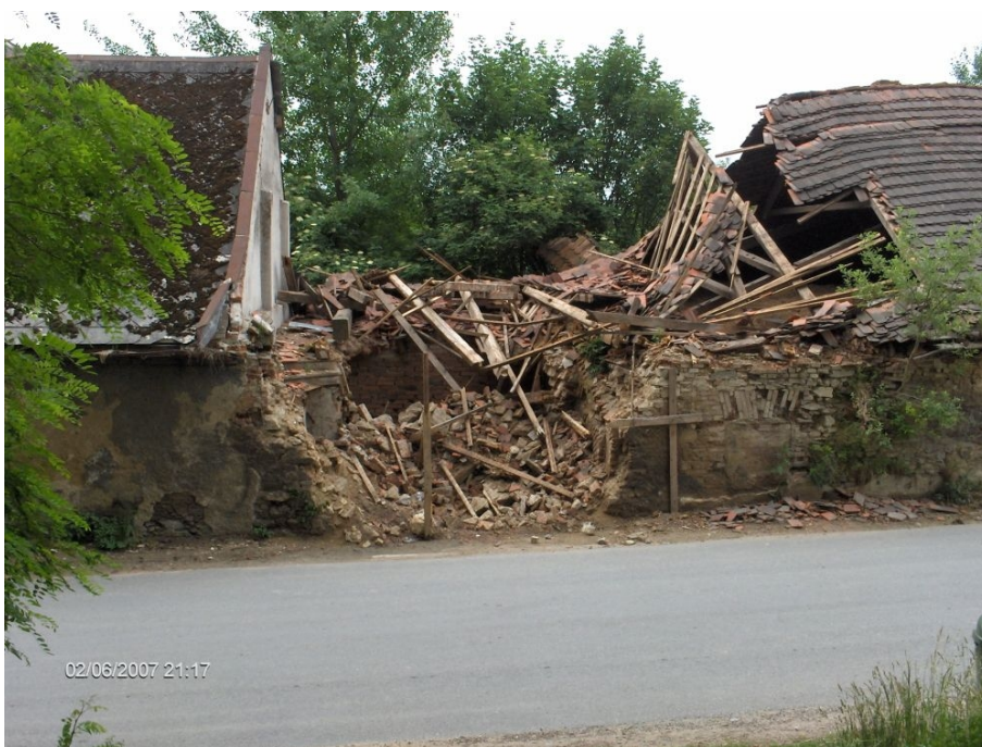
Obrázek 47: Zřícení hospodářského dvora na pozemku parc. č. 74. 2007. Zdroj: vlastní
