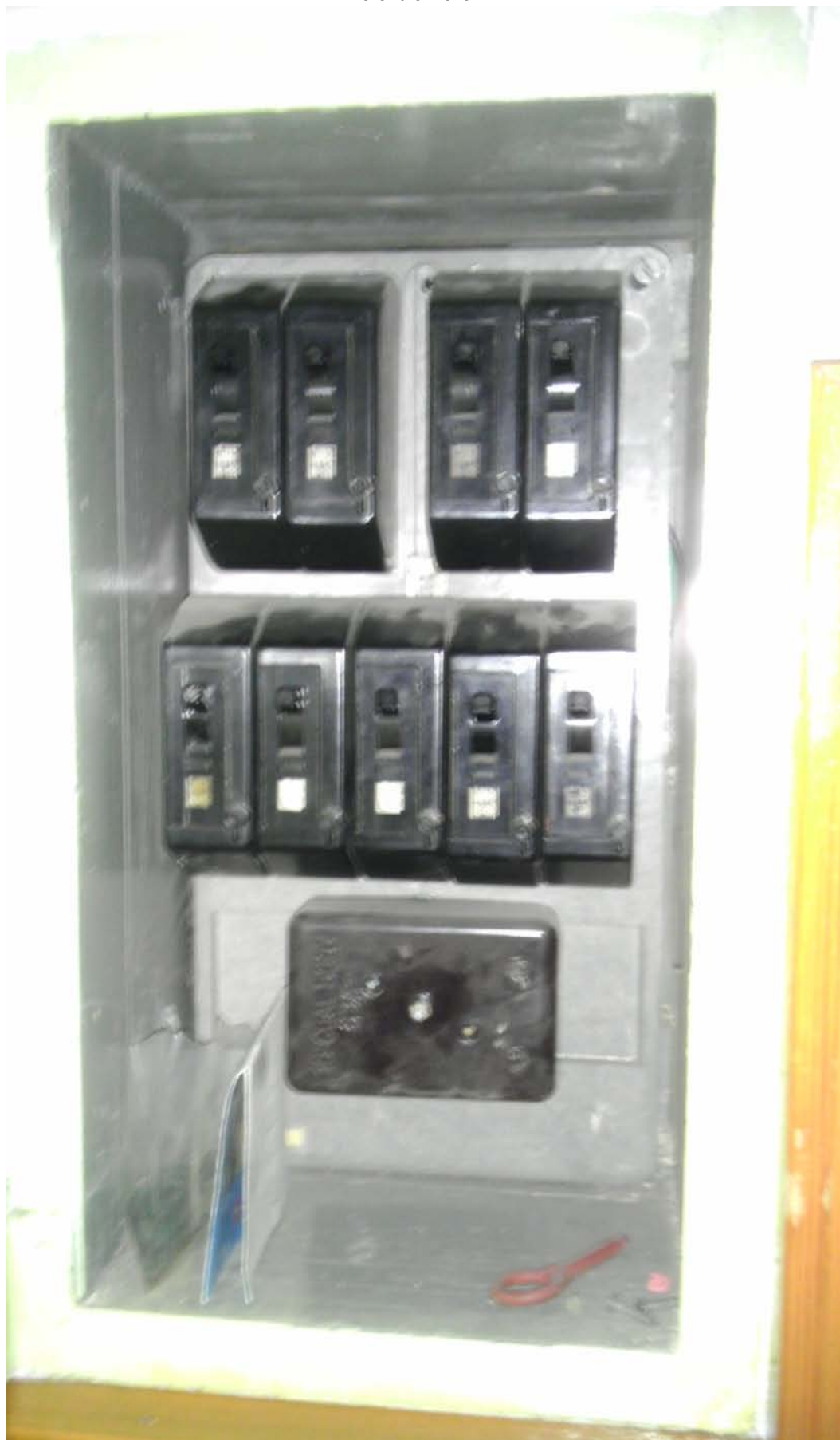
Obr. p2 stávající rozvaděč v domě
