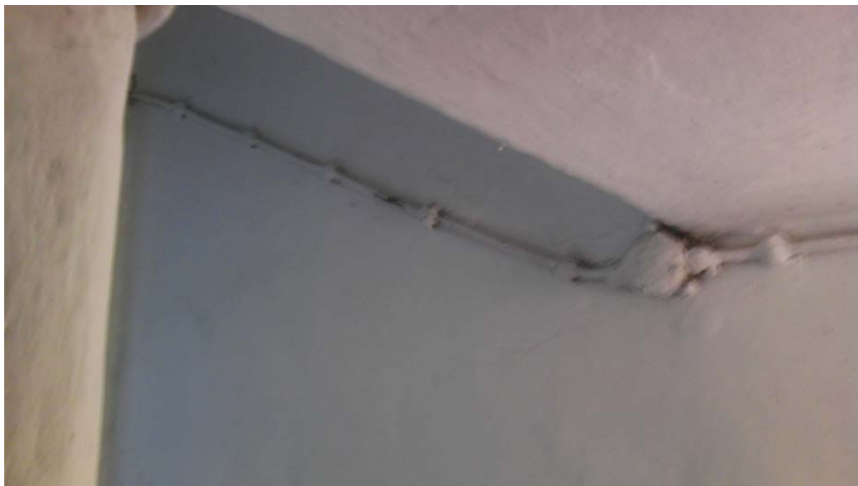
Obr p4b současné řešení rozvodů na schodišti do sklepa
