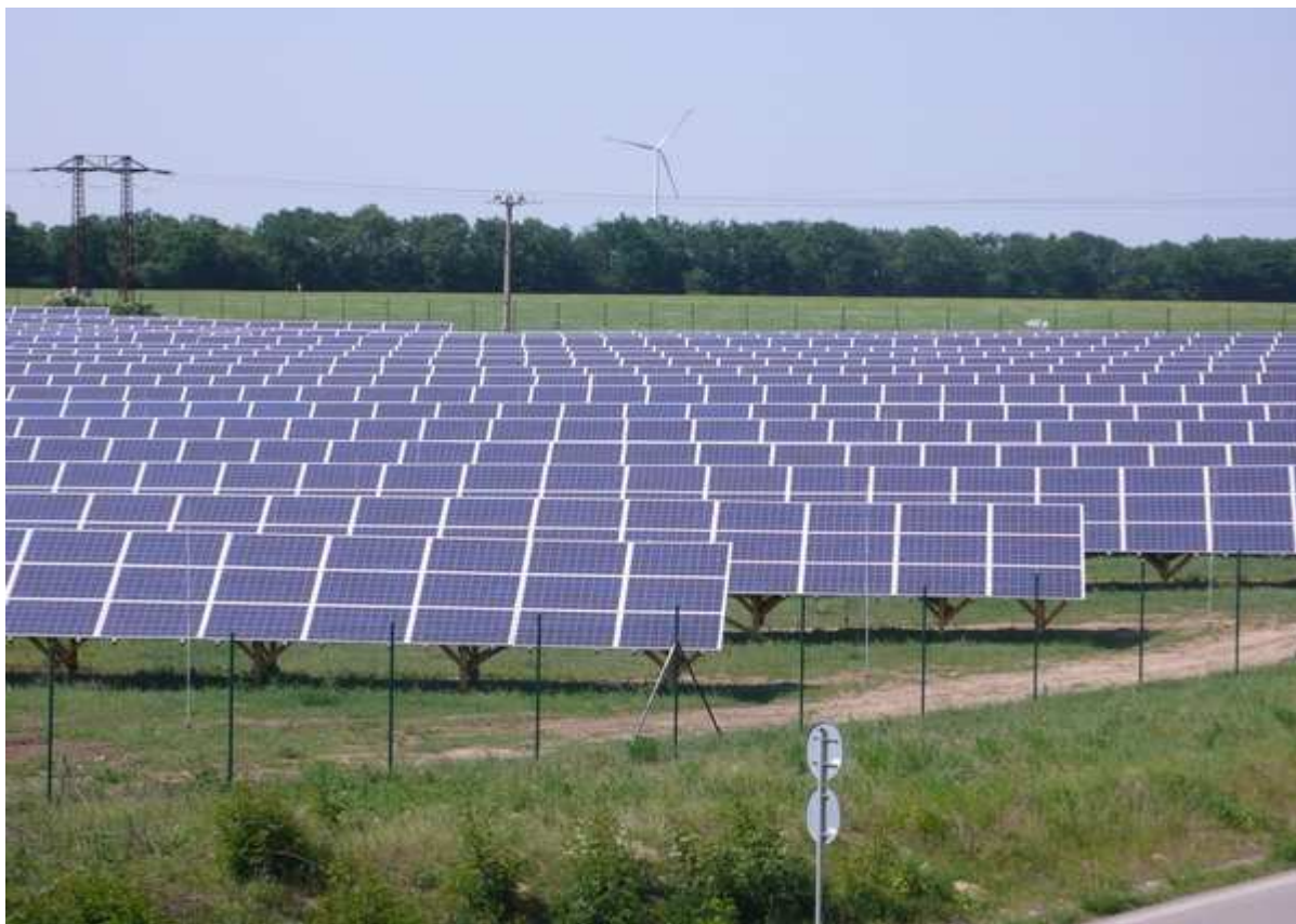
Obrázek 21: Ukázka typické fotovoltaické elektrárny [7]
