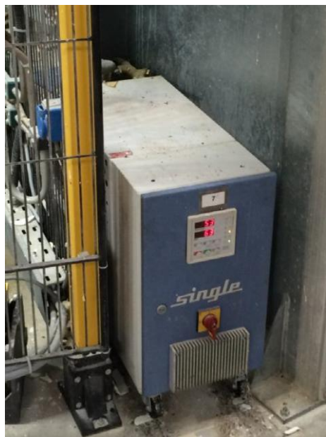
Obr. č. 15: Nahřívací zařízení
