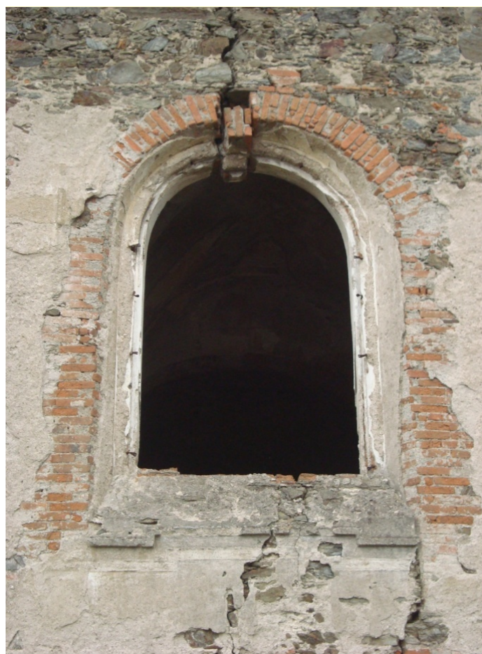
Obr. 79 Kostel sv. Barbory – detail poškození. Uvolněné zdivo v zaklenutí okna v severní kapli (foto autorka, 2016).
