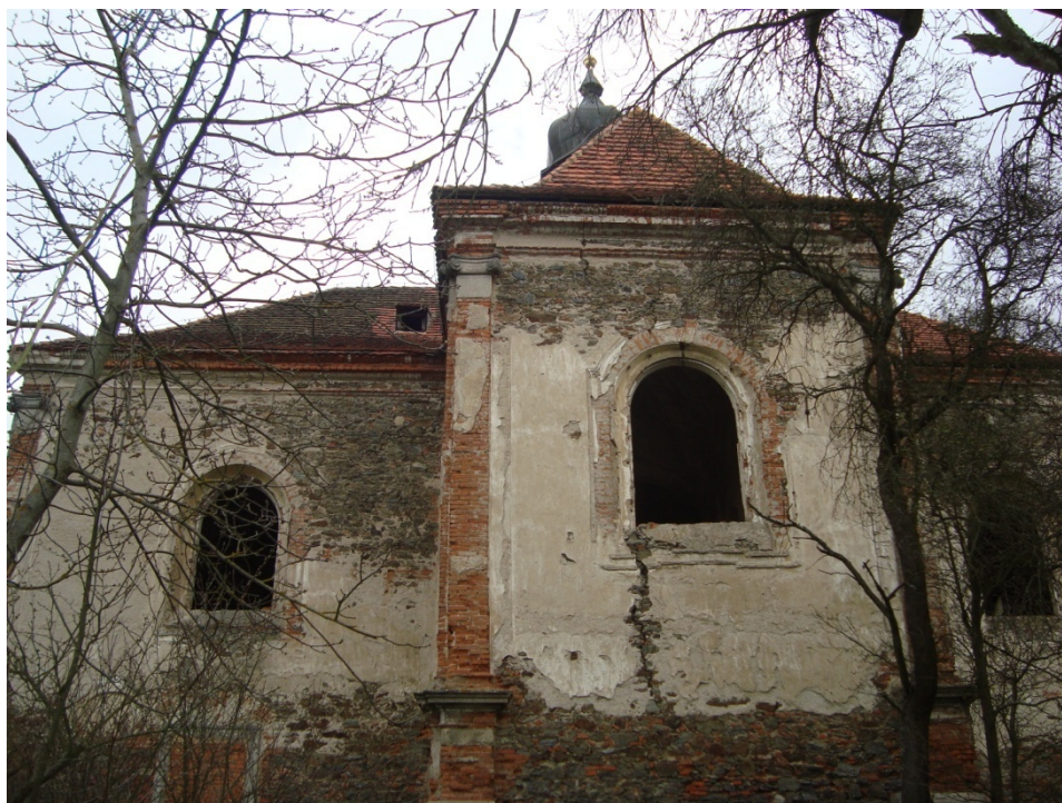
Obr. 77 Kostel sv. Barbory – jižní strana. Detail poškození (foto autorka, 2016).
