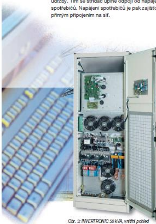
Obr. 3: INVERTRONIC 50 kVA, vnitřní pohled
