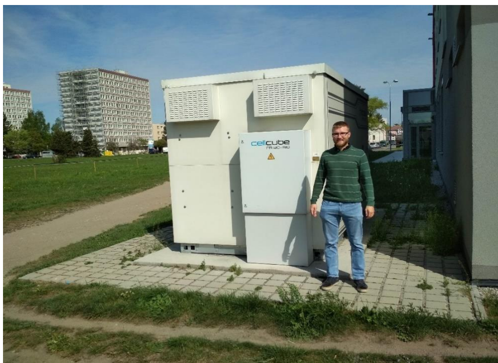
Obr. 2.6 Vanad redoxní průtoková baterie JVTP v Českých Budějovicích
