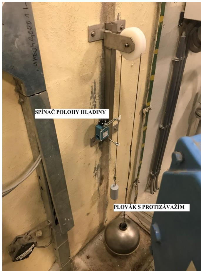
Obrázek 8.8: Instalace havarijního plováku se spínačem. Zdroj vlastní
