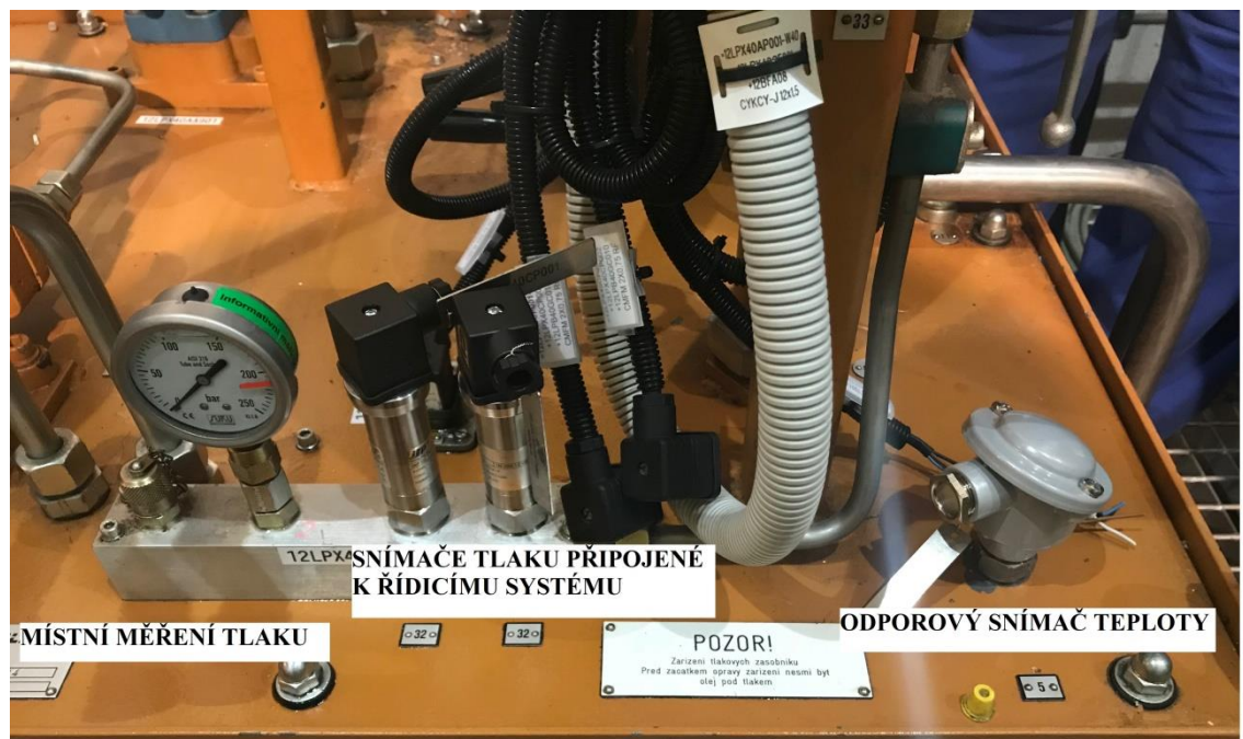
Obrázek 8.2: Olejové hospodářství se snímači tlaku, manometrem a odporovým teploměrem. Zdroj vlastní
