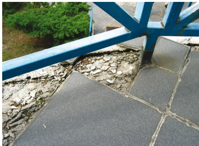
Obr. 25 – porucha podlahy – odpadávání dlažby [16]
