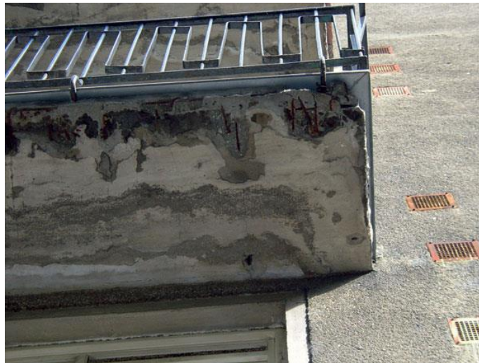
Obr. 24 – porucha nosné konstrukce [15]
