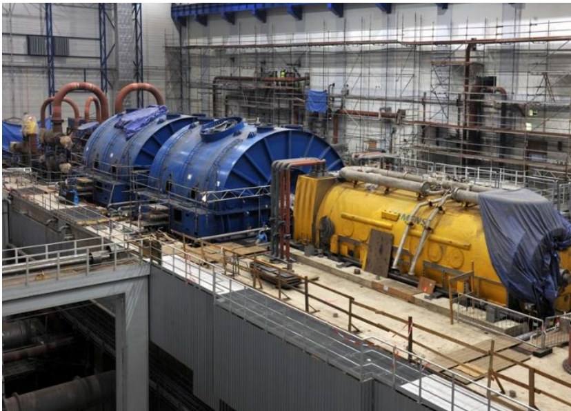
Obr. č. 19: Strojovna nový zdroj 660MW
