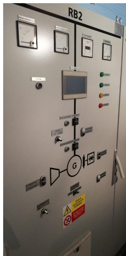
Obrázek 5.11 Rozváděč buzení a fázování
