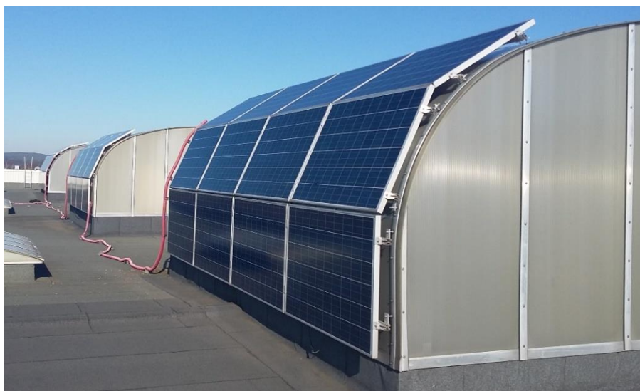
Obr. 2.5 FVE orientovaná na západ
