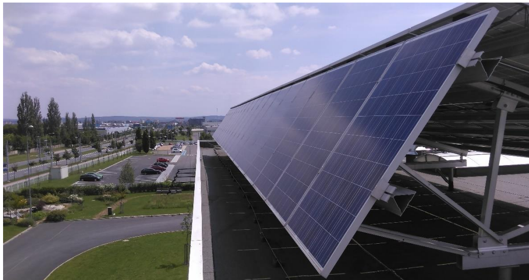
Obr. 2.3 FVE orientovaná na sever
