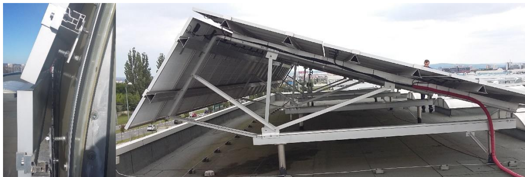
Obr. 2.7 Nosná konstrukce FVE-Z (vlevo) a FVE-J+S (vpravo)
