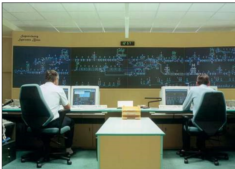
Obr. 3.2 Interiér velínu sítě kotelen (převzato z [6])
