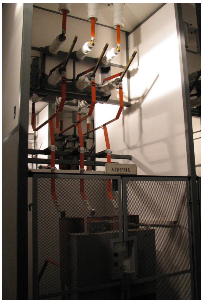
Obr. č. 3 – Vývodová kobka č.10 – Nepomuk
