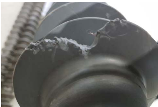
Obr. 2.11 – Poškození izolátoru okusem – stav po 9-ti letech provozu 66
