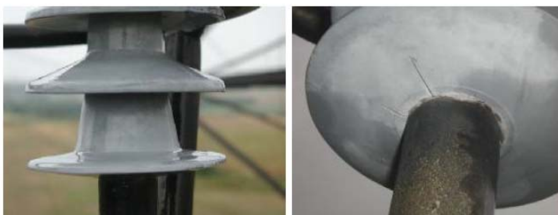
Obr. 2.9 – Praskliny u spodní koncové kovové armatury – stav po 18-ti letech v provozu 64
