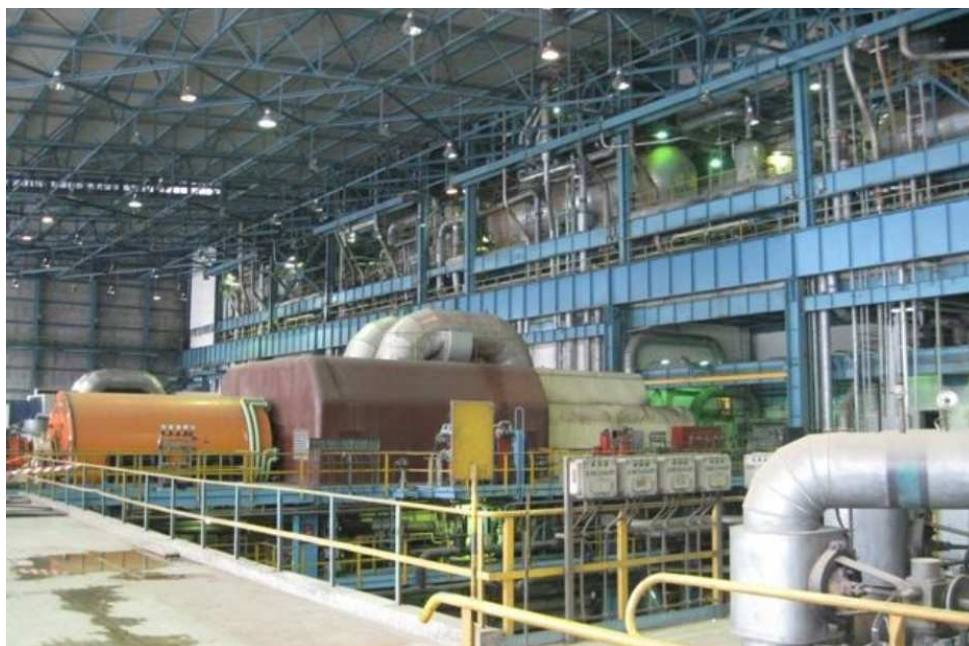
Obrázek 2: Pohled do strojovny - elektrárna Pruněřov II.
