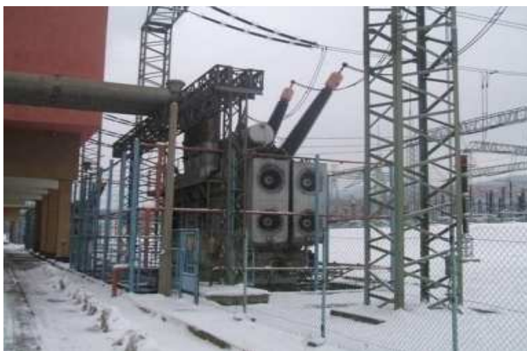
Obrázek 4: Pohled na blokový transformátor 250 MVA 15,7/400 kV.
